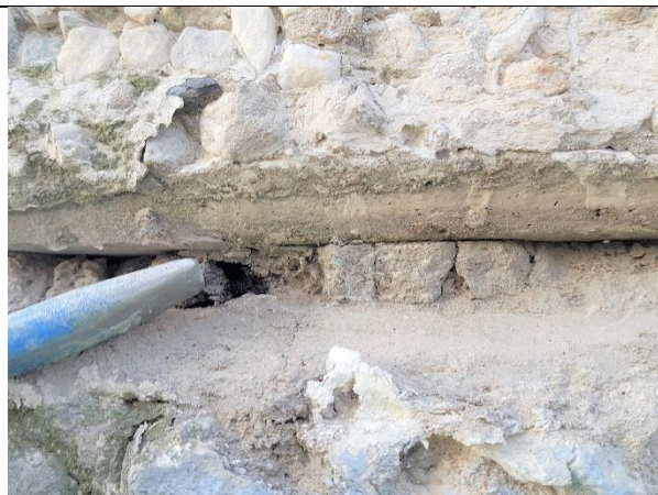
4.1.8.att. Starppaneļu šuves atsegums Nr.4 1.stāva līmenī. Virspusē cementa javas kārtā 15 mm, tad apaļveida blīvējums (paroizol) d30. Mastikas kārtā šajā šuvē nav konstatēta.
