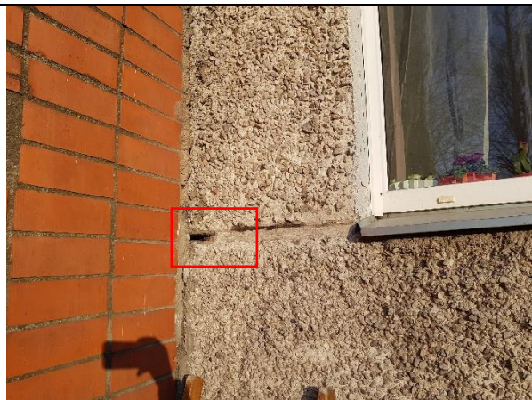
4.1.6.att. Starppaneļu šuves atsegums Nr.3 1.stāva līmenī (sk. kopā ar att. 4.1.7.)
