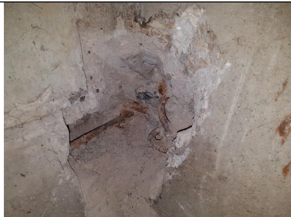
1.7.2.att. Savienojuma elementiem veikta nav pretkorozijas apstrāde. Konstatējama nebūtiska, virspusēja korozija. Mezgls aizbetonēts ar cementa-smilšu javu.
