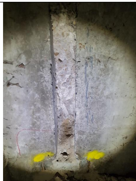
1.3.2.att. Pēc atkalšanas 250 mm dziļumā, metāla stiprinājuma elementi netika konstatēti. Ņemot vērā, ka aizdare veikta kvalitatīvi un ar augstas stiprības betonu, mezgla atsegšana netika turpināta.
