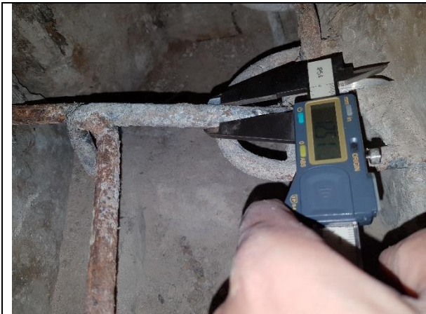
1.1.5.att. Cilpveida izlaidumi un savienojošās skavas gludās, ar diametru 12 mm, kas ir atbilstoši Projektā paredzētajam d12 AI (sk. att. 1.1.7, 1.1.8, 1.1.9).
