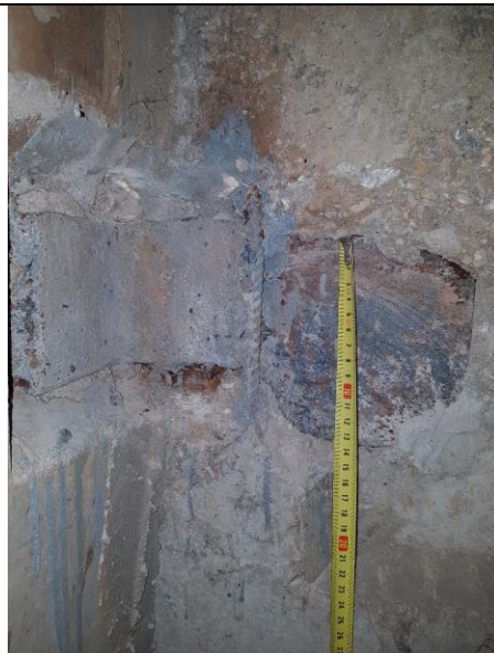
1.4.2.att. Atsegta paneļa ПBC20-1 nesošā stiegra d12 ar profilējumu. Savienojuma elementiem veikta pretkorozijas apstrāde un ierīkota cementa javas aizsargslānis 15-20 mm.
