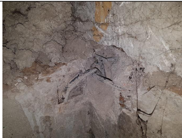
1.6.2.att. Savienojuma elementiem veikta pretkorozijas apstrāde un mezgls aizbetonēts ar cementa-smilšu javu. Konstatējama nebūtiska korozija (pretkorozijas apstrāde veikta nekvalitatīvi).
