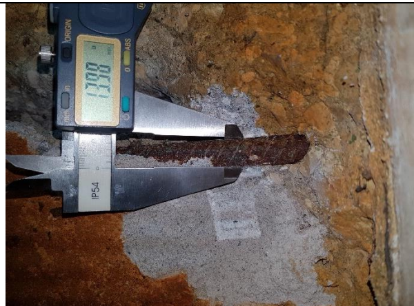
1.8.2.att. Pārseguma paneļa nesošā stiegra d14. Atsegums ilglaicīgi atradies bez aizsargkārtas, tāpēc vērojama virspusēja stiegrojuma korozija.
