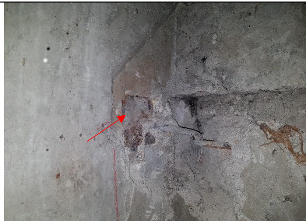
1.5.2.att. Savienojuma elementiem veikta pretkorozijas apstrāde un mezgls aizbetonēts ar cementa-smilšu javu. Konstatējama nebūtiska korozija (ieliekamai detaļai pretkorozijas apstrāde vistīcāmāk nav veikta).
