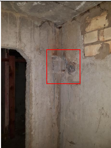
1.4.1.att. Nesošās šķērssienu ПBC16-1A (biezums 180 mm) un garensienas ПBC20-1 (biezums 150 mm) savienojums. Konstatējamas nebūtiskas korozijas pazīmes.
