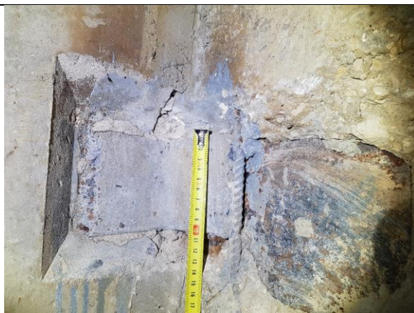
1.4.3.att. L-veida elements 8 mm biežumā, piemētināts pie paneļu ieliekamajām detaļām, šuves katete 6mm, atbilstoši projektam.
