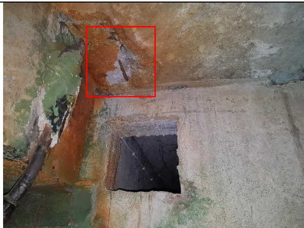
1.8.1.att. Pārseguma paneļa П1-24РТ nesošo stiegru atsegums. Nesošo stiegru diametrs ir atbilstošs Projekta risinājumam (att. 1.8.3.).
