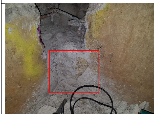
2.1.17.att. Ēka Salacas ielā 17, ārsienu monolitizētās šuves betona virsma, pie atseguma A1
