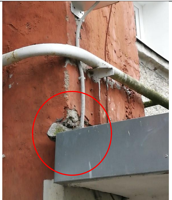
4.9.15.att. Izdrupums betonā virs ieejas jumtiņa. Salnas iela 1, Rīga.
