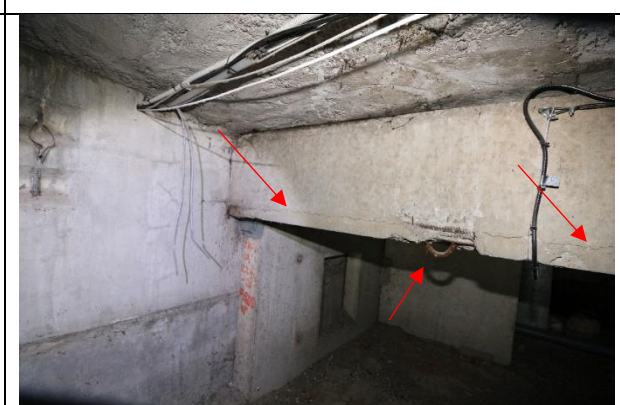
4.8.8. attēls. Teknes stūrī atsegts stieģrojums. Nepietiekama stieģrojuma aizsargslāņa dēļ, kā arī mitruma infiltrācijas rezultātā veidojas stieģrojuma korozija un plaisa virs stieģrojuma visā teknes garumā 1.sekcija. Vīlpa iela 8, Rīga.
