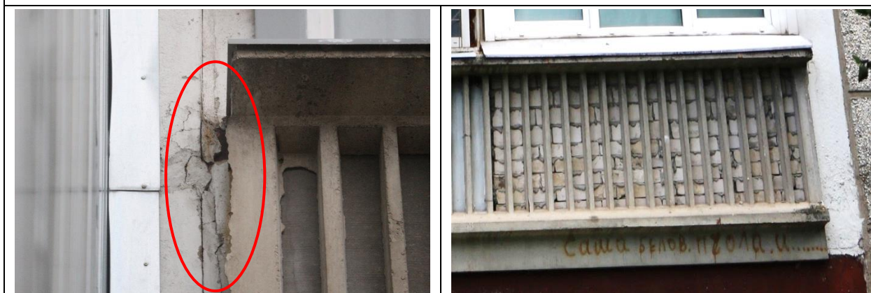
4.9.4.att. Ievērojami betona izdrupumi. Dzērvju iela 10, Rīga.
