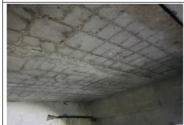
4.8.5.att. Jumta pārseguma paneļa konstruktīvā stieģrojuma korozija, nepietiekama betona aizsargkārtā. Rītupes iela 28, Rīga.
