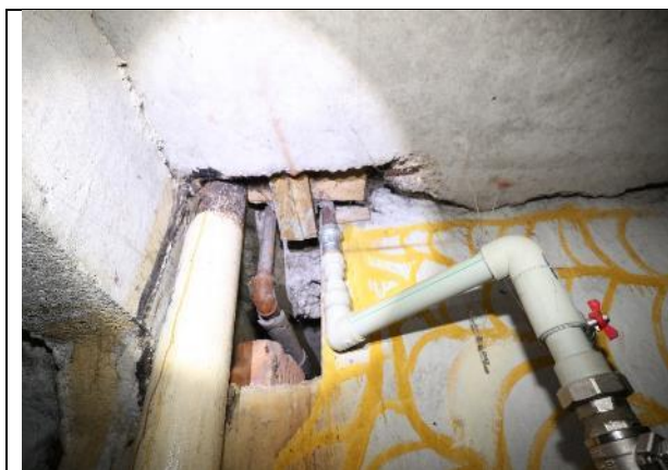
4.14.1. attēls. Ar nepiemērotiem izstrādājumiem noblīvētas inženiersistēmu cauruļvadu šķērsojumu vietas, pagraba telpa
