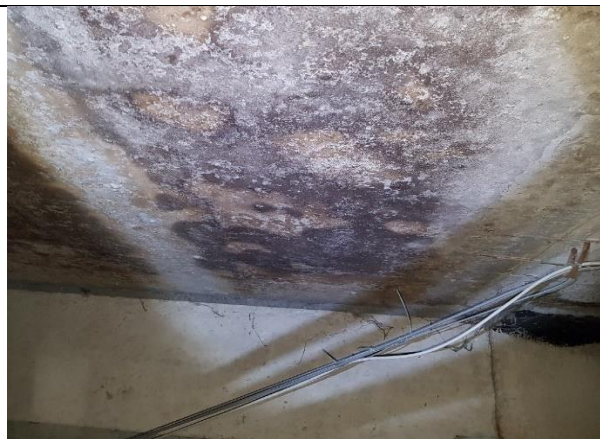
4.8.10.att. Jumta pārseguma plātnes betona struktūra bojāta mitruma un sala iedarbībā. Edžiņa gatve 1, Rīga.
