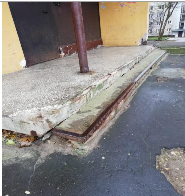
4.9.11.att. Metāla ieliekamās detaļās korodējušas. Edžiņa gatve 1, Rīga.
