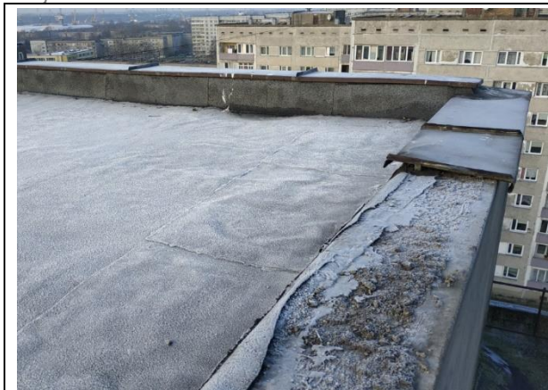
4.8.15. attēls. Parapeta nosedzošie skārda elementi zuduši. Edžiņa gatve 1, Rīga.
