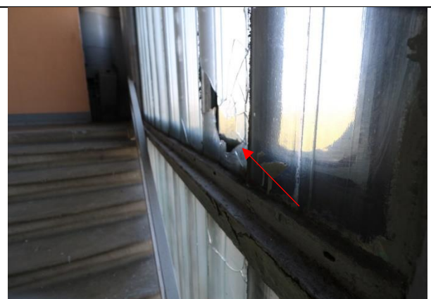
4.13.22. attēls. Stikla profilītu bojājums kāpņu telpā. Vīlpa iela 8, Rīga, 1.sekcija, 9.stāvs.
