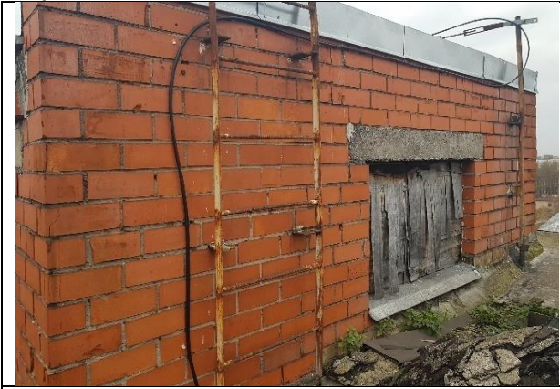
4.10.2. att. Kāpnes metāla konstrukcijās, nokļūšanai uz kāpņutelpas jumtu – ar ievērojamu koroziju.
