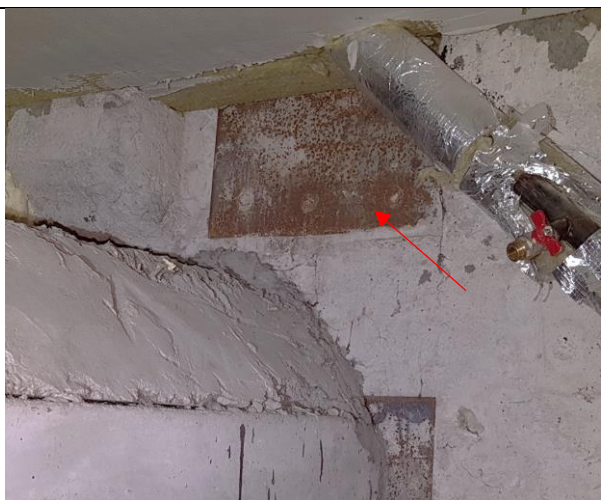
4.3.9.att. Ieliekamo detaļu korozija. Jasmuižas iela 8, Rīga.
