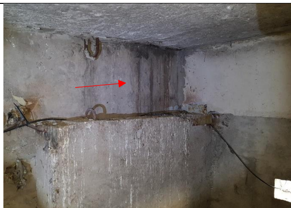
4.4.13. attēls. Pašnesošo sienu bojājumi mitruma ietekmē, nehermētisku jumta konstrukciju dēļ (bēniņu telpa)
