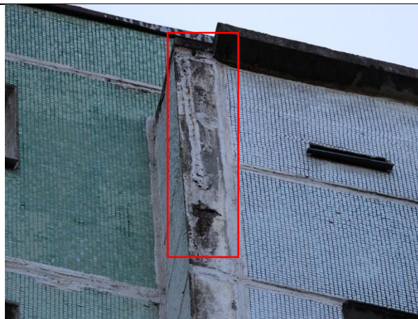
4.4.9. attēls. Bojāts krāsojums. Izdrupumi sala un mitruma iedarbības rezultātā, atsegts stiebrojums, ZA fasāde. Vīlipa iela 8, Rīga.
