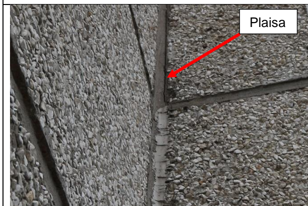
4.5.7. attēls. Lokāli remontēta saduršuves vieta, pielietojot dažādus materiālus, sadurvietā - plaisa.
