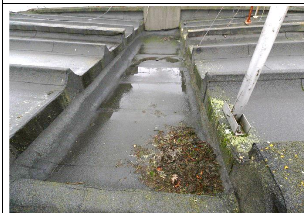
4.8.17.att. Koka lapu un putekļu saneši dzelzsbetona tekņē. Vīlpa iela 8, Rīga.
