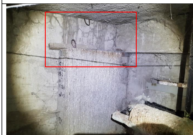
4.4.6. attēls. Mikroplaisu tīkls un ievērojami mitruma bojājumi nehermētisku jumta konstrukciju un elementu savienojumu rezultātā. Vīlpa iela 8, Rīga.
