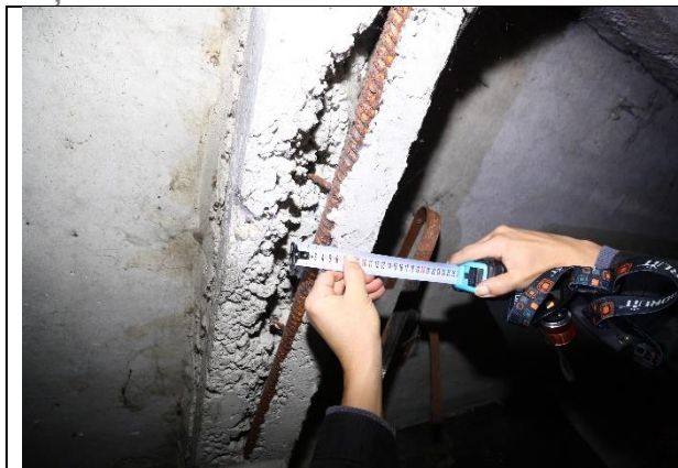
4.2.9.att. Nesošā dzelzsbetona šķērssienu pagraba stāvā – 180 mm biezumā. Ražošanas defekts. Dzērvju iela 10, Rīga.
