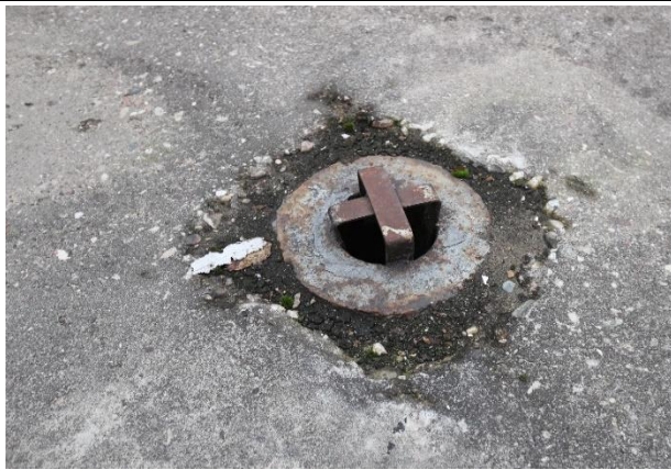
4.8.25.att. Iekšējās lietusūdens kanalizācijas izvadam nav nodrošināta piltuves aizsargrestes Rītupes iela 10, Rīga.
