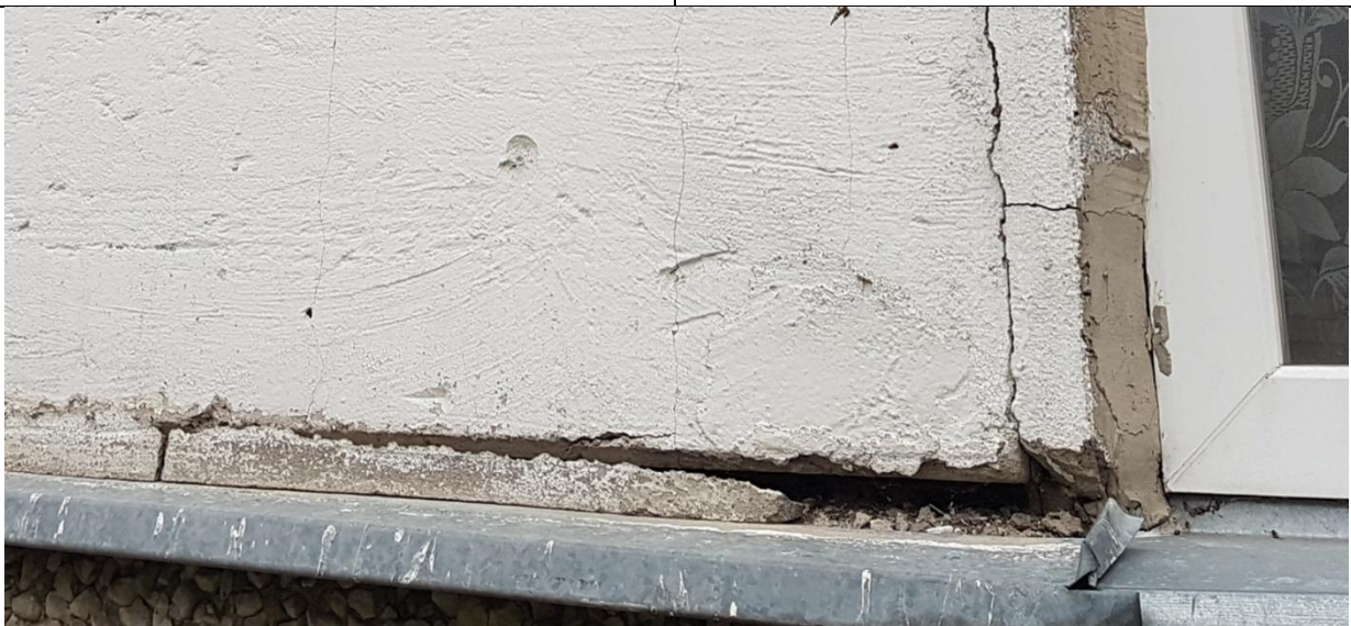
4.13.26.att. Bojāts gāzbetona panelis – plaisas, izdrupumi. Edžiņa gatve 1, Rīga.
