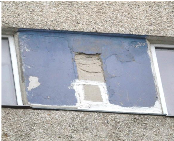
4.13.14.att. Gāzbetona paneļi ailas aizpildījumā starp logiem – neapmierinošā stāvoklī. Jasmuižas iela 12, Rīga.
