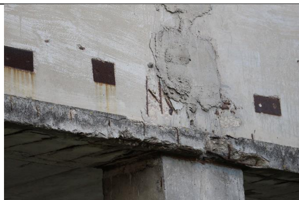
4.3.3.att. Sijas apakšējā plauktā betona izdrupumi, atsegts stieģrojums un ielikamo detaļu korozija
