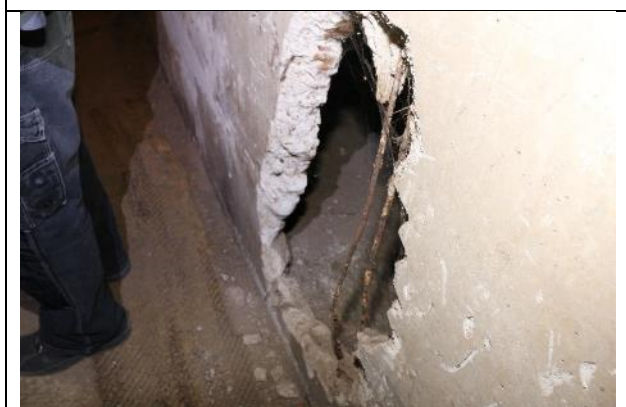
4.11.2. attēls. Ģipšbetona starpsienai lokāls izdrupums.
