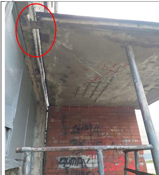
4.9.6.att. Rezerves ejas mezgla jumtiņa konstrukcija atdalījies no ēkas. Jumtiņš ēkai Salacas ielā 17 ir avārijas stāvoklī, to nekavējoties jādemontē.
