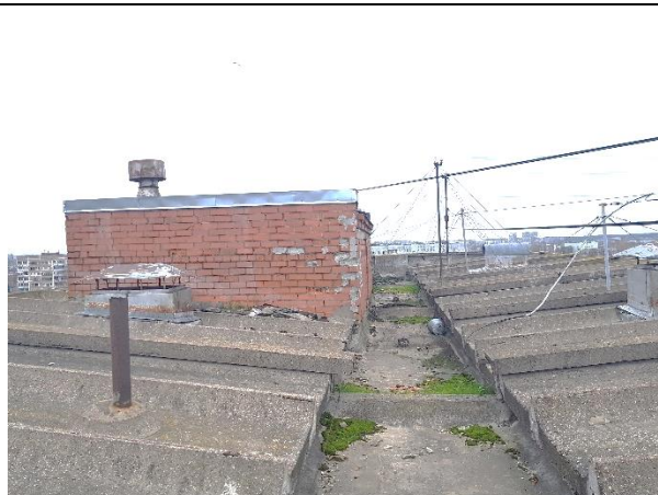
4.8.20.att. Noslīdējuši nosegelementi. Jumts bez aizsargpārklājuma. Mastikas un saules aizsargpārklājums pilnībā bojāts. Rītupes iela 28, Rīga.
