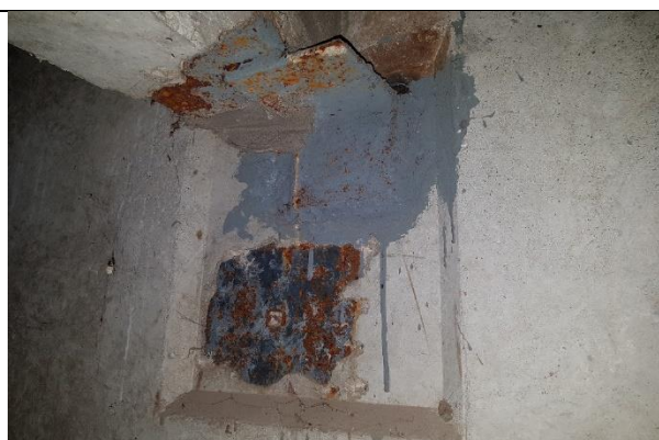
4.2.12. attēls. Nesošo šķērssienu paneļu ieliekamo detaļām korozijas bojājumi, pretkorozijas pārklājums ierīkots nekvalitatīvi. Salacas iela 17, Rīga.
