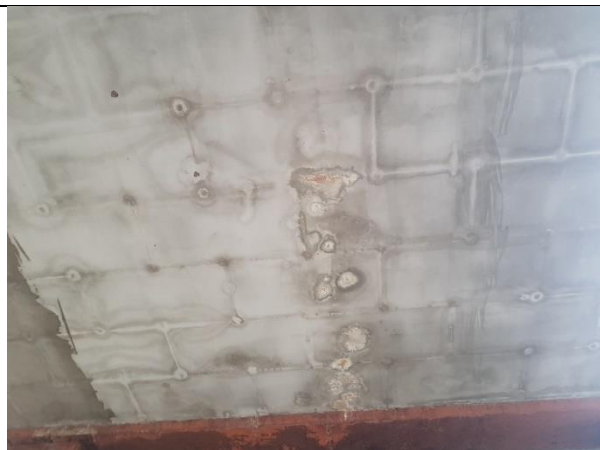
4.5.13.att. Tehniskā stāva siltinājums no apakšas – konstatēta mitruma filtrācija caur siltumizolācijas slāni (ēkas Jasmuižas ielā 8, Rīgā).
