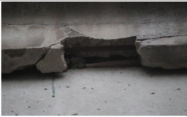
4.9.8.att. Bojājumi lodžijas norobežojošā elementa apakšējā joslā. Dzērvju iela 10, Rīga.
