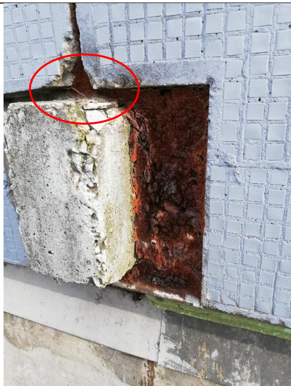
4.9.1.att. Lodžiju norobežojošos ekrānos atsevišķās vietās betona fragmentu nodrupumi. Rītupes iela 28, Rīga.
