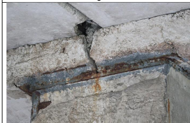
4.3.4.att. Bojājumi un nehermētiskums pārseguma plātnes balsta vietā uz sijas apakšējā plaukta
