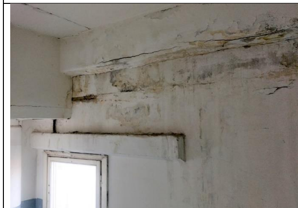
4.4.12. attēls. Kāpņu telpas ārsienas bojājumi (9.stāvs) mitruma ietekmē, nehermētisku starppaneļu šuvju un jumta seguma dēļ
