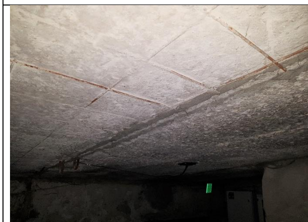
4.8.11.att. Jumta pārseguma plātņu apakšējā virsma nekvalitatīva, stiegrojuma aizsargkārtā nav pietiekama, kas ir ražošanas defekts. Edžiņa gatve 1, Rīga.
