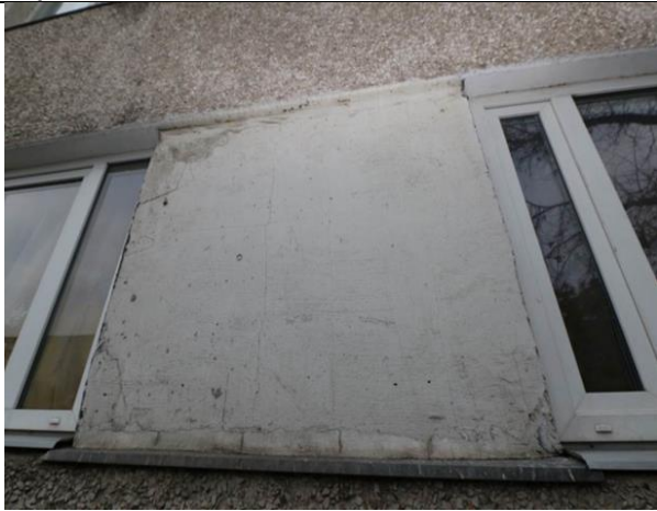
4.13.24. attēls. Bojāts gāzbetona panelis – plaisu tīkls, izdrupumi, malu defekti
