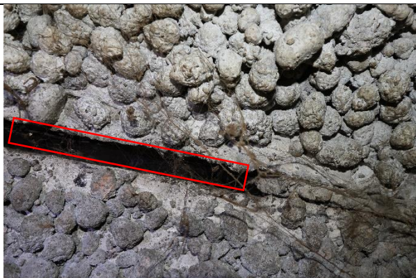
4.5.4.att. Jumta pārseguma paneļu saduršuves aizpildījums atdalījies Ēkas ekspluatācijas laikā
