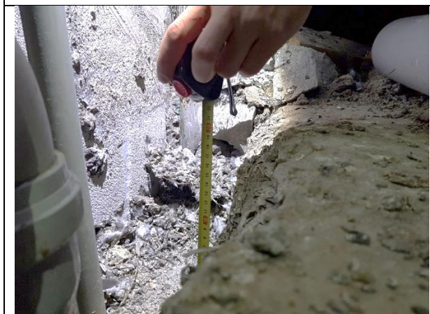
4.5.14. attēls. Bēniņu pārsegumam ierīkota siltumizolācijas kārtā no 200 mm biežām fibrolīta loksnēm. Salacas iela 17, Rīga.
