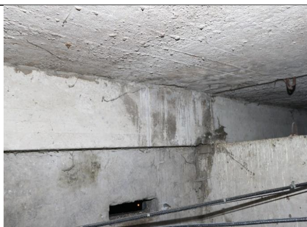
4.8.12.att. Nesošās dzelzsbetona sijas PK1. Mitruma bojājumi dēļ nehermētiskas jumta konstrukcijas. Projekta risinājumu skatīt 4.8.2.attēlā. Salacas iela 17, Rīga.
