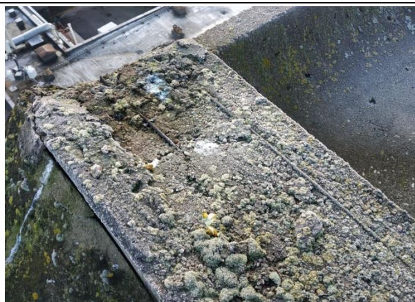
4.8.16. attēls. Parapeta nosedzošie dzelzsbetona elementi vietām pilnībā sadrupuši. Edžiņa gatve 1, Rīga.
