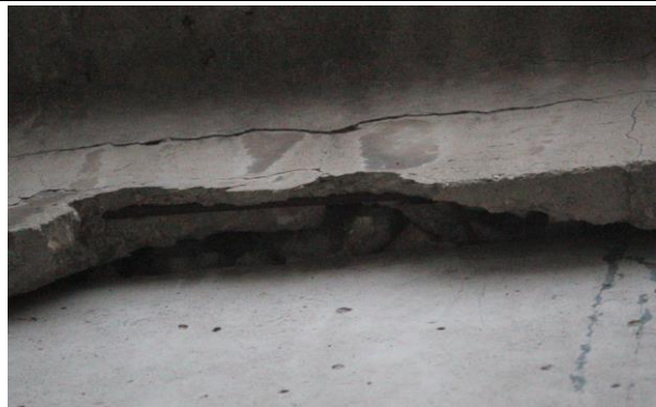
4.9.9.att. Bojājumi lodžijas norobežojošā elementa apakšējā joslā. Dzērvju iela 10, Rīga.
