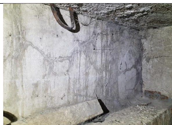
4.4.7. attēls. Mikroplaisu tīkls un ievērojami mitruma bojājumi nehermētisku jumta konstrukciju un elementu savienojumu rezultātā, bēniņu telpās. Vīlpa iela 8, Rīga.
