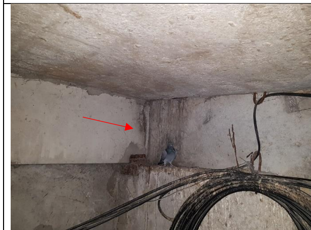
4.4.10. attēls. Mitruma bojājumi uz ārsienu paneļiem ēkas bēniņos, nehermētiska jumta seguma rezultātā
