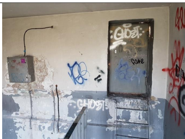
4.2.14. attēls. Mitruma un ūdens filtrācijas rezultātā radīti bojājumi kāpņu telpas mūra sienu un dzelzsbetona sienu paneļu sadurvietā (Vīlpa iela 8, Rīga, 6.sekcija)
