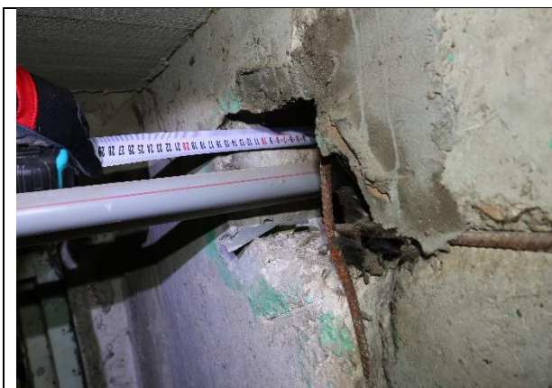
4.2.7.att. Nehermētiski komunikāciju vietu šķērsojumi nesošajās sienās tehniskajā stāvā, kas neatbilst ugunsdrošības prasībām. Atsegtis un korodējis stiegrojums.
