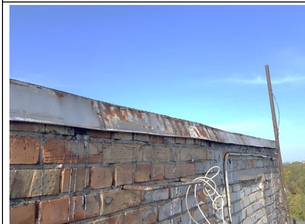
4.8.19. attēls. Parapeta skārda nosedzētaļas virs ārsienām saglabājušās no būvniecības laika, uzstādītas nekvalitatīvi un daudzās vietās korodējušas, 5.sekcija. Vīlpa iela 8, Rīga.
