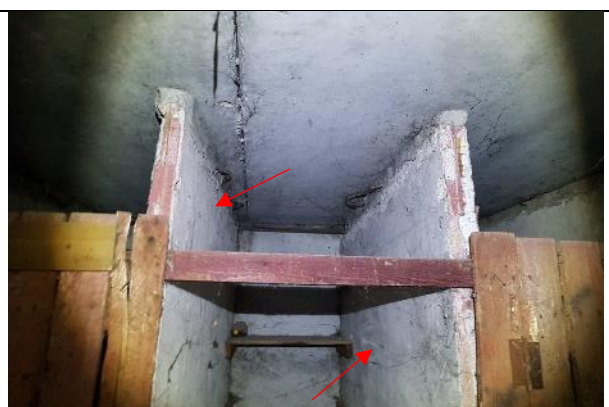
4.11.3. attēls. Ģipšbetona starpsienas saplaisājušas, atrodas neapmierinošā tehniskā stāvoklī
