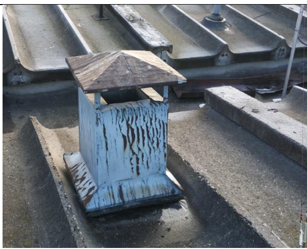
4.16.2. attēls. Vēdināšanas izvads caur atvērumu jumta pārseguma plātnē. Skārda elementi ir korodējuši.
