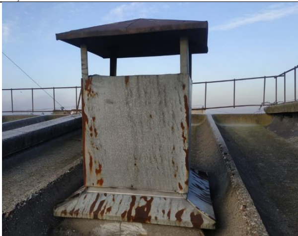
4.16.3. attēls. Vēdināšanas izvads caur atvērumu jumta pārseguma plātnē. Skārda elementi ir korodējuši.
