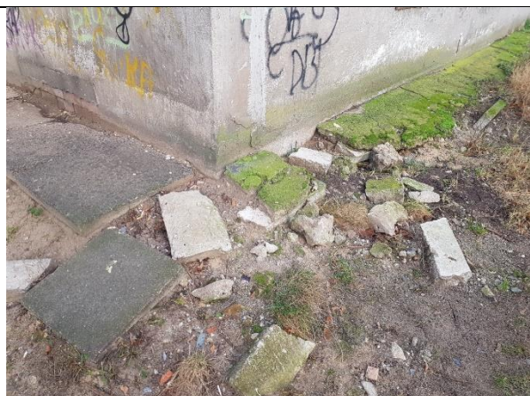
4.1.6. attēls. Ēkas aizsargapmale pilnībā sadrupusi
