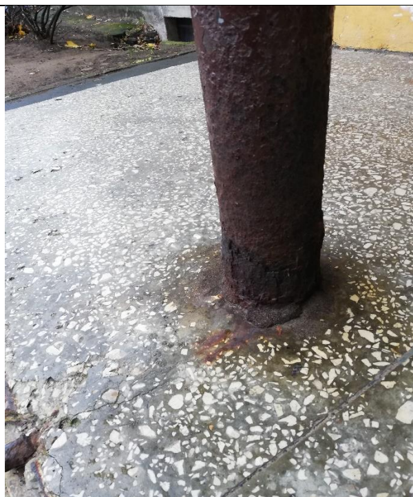
4.9.13.att. Korodējusi jumtiņa balsta apaļcaurule. Edžiņa gatve 1, Rīga.
