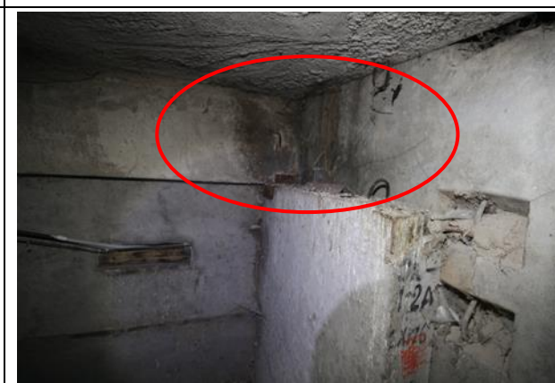
4.8.6. att. Nokrišņu ūdens infiltrācijas pazīmes caur bojātiem jumta elementiem un sadurvietām. Rītupes iela 28, Rīga.
