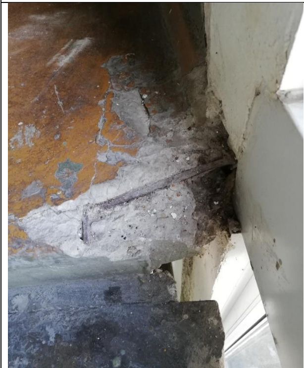
4.10.4.att. Kāpņu laukuma un kāpņu laida sadurvietā betona izdrupums ar mitruma bojājumu pazīmēm. Vīlīpa iela 8.
