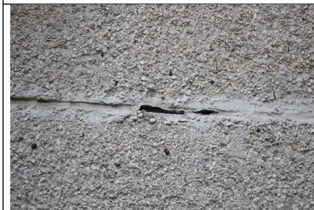
4.5.5.att. Kāpņu telpas ārsienu paneļu šuvju bojājums apkārtējās vides ietekmes rezultātā
