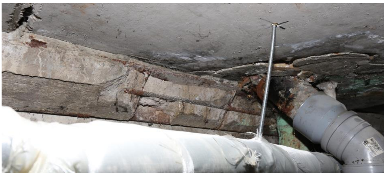
4.3.8.att. Iekšējās sijas (sienas) būtiskie bojājumi pārsegumu balsta vietā – konsoles izdrupumi, atsegts stiegrojums un ieliekamās detaļas. Lubānas iela 16, Rīga.
