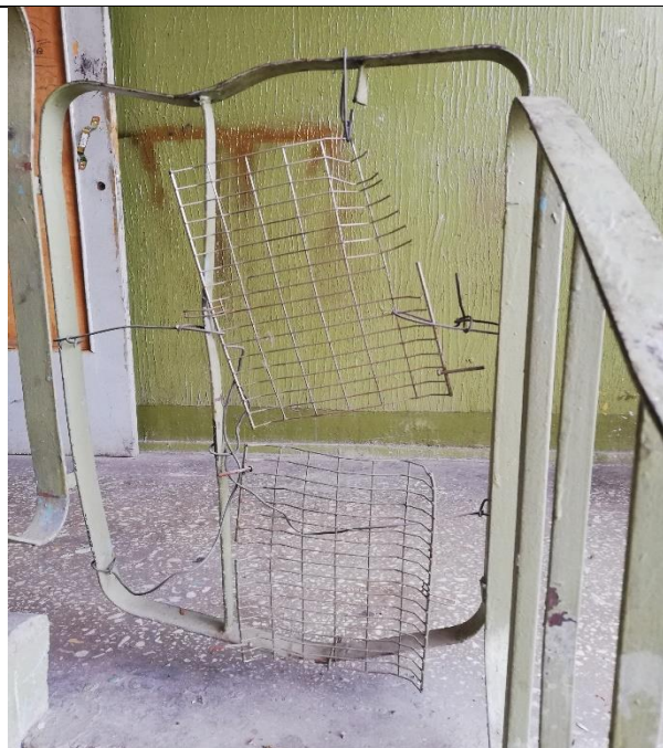
4.10.7.att. Konstatēta margu norobežojošās konstrukcijas bīstamība. Salacas iela 17.
