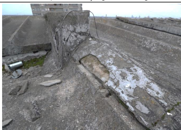
4.8.18. attēls. Jumta parapetu nosedzošie dzelzsbetona elementi ar mitruma un sala ietekmē bojātu betona struktūru, vietām pilnībā sadrupuši. Salacas iela 17, Rīga
