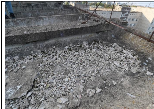
4.8.9.att. Jumta plātņu ievērojama betona destrukcija. Lubānas iela 16, Rīga.
