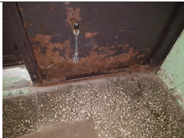
4.13.6. attēls. Ieejas mezgla metāla durvis ar korozijas bojājumiem
