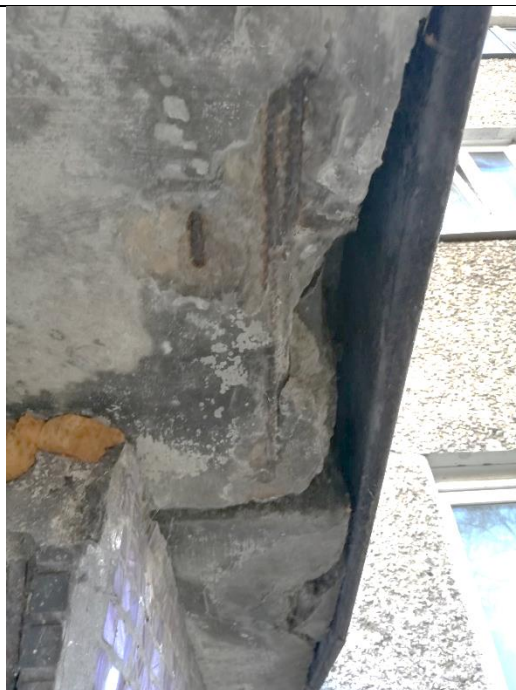
4.9.7.att. Mitruma un sala ietekmē izdrupusi jumtiņa plātnes mala, atsegts stiebrojums. Salacas iela 17, Rīga.
