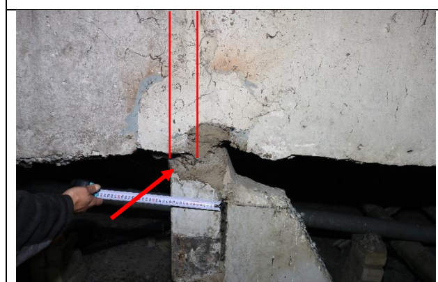
4.8.7.att. Dzelzsbetona jumta tekņu balsta vieta uz sienas elementa СК, ~60 mm. Dzērvju iela 10, Rīga.
