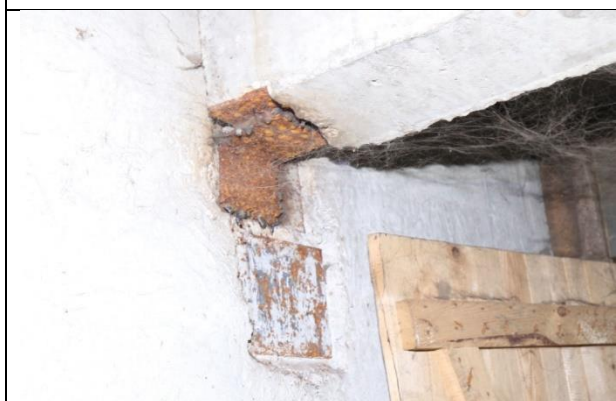
4.2.11. attēls. Nesošo šķērssienu paneļu ieliekamās detaļas ar korozijas bojājumiem (2.sekcija, pagrabs). Vīlpa iela 8, Rīga.
