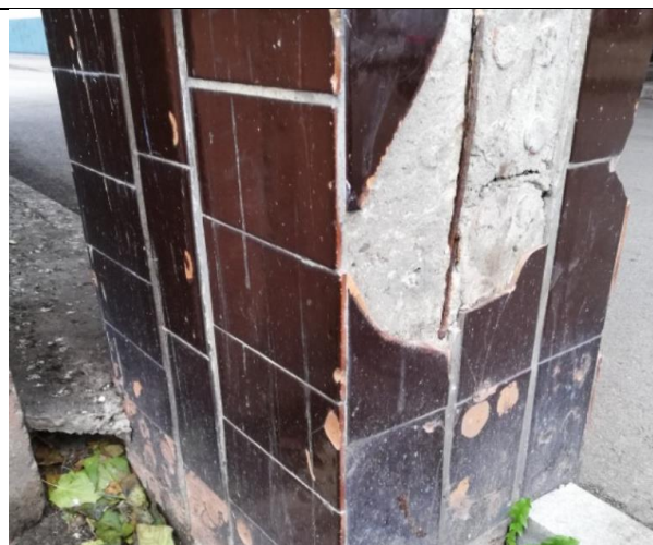
4.3.10.att. Kolonnu apdares bojājumi. Salnas iela 1, Rīga.
