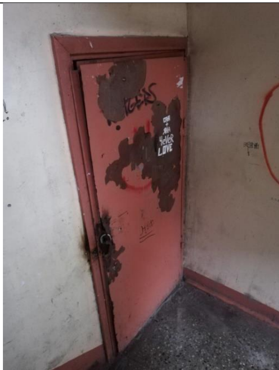
4.13.2.att. Metāla durvis neapmierinošā tehniskajā stāvoklī
