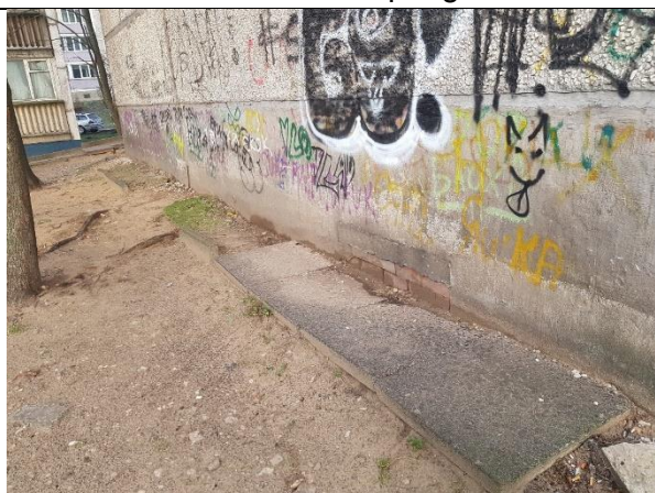
4.1.7. attēls. Ēkas aizsargapmale ar iesēdumiem, atsevišķi posmi zuduši
