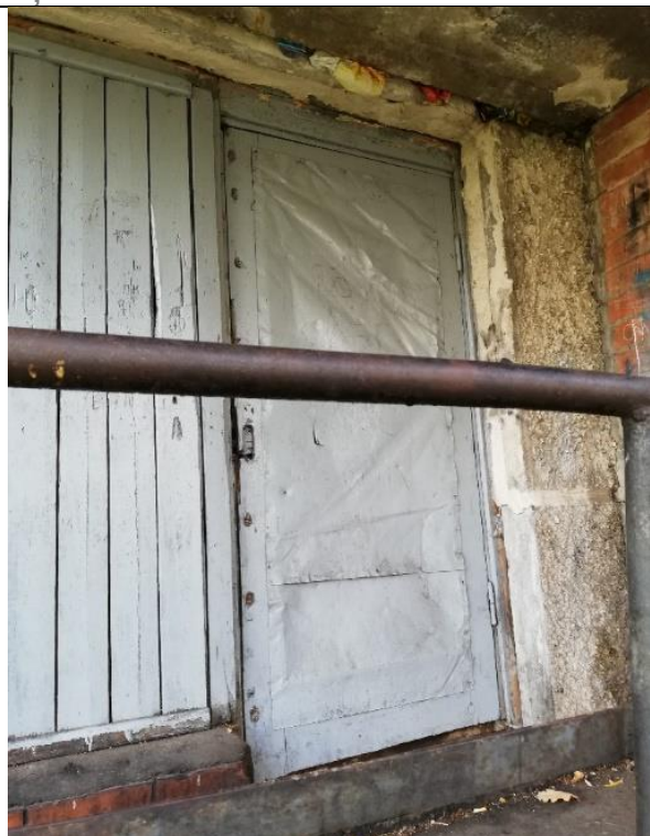
4.13.1.att. Rezerves ieejas durvis neapmierinošā tehniskā stāvoklī.
