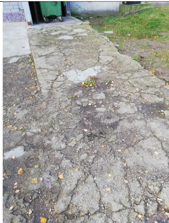
4.10.5.att. Panduss neapmierinošā tehniskajā stāvoklī. Salacas iela 17, Rīga.
