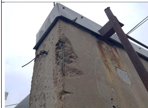
4.2.13.att. Jumta virs kāpņu telpas nesošā siena no gatavelementu paneļiem, ar virsmas nodrupumiem, ieliekamo detaļu un atsegtā stiebrojuma koroziju. Dzērvju iela 10, Rīga.
