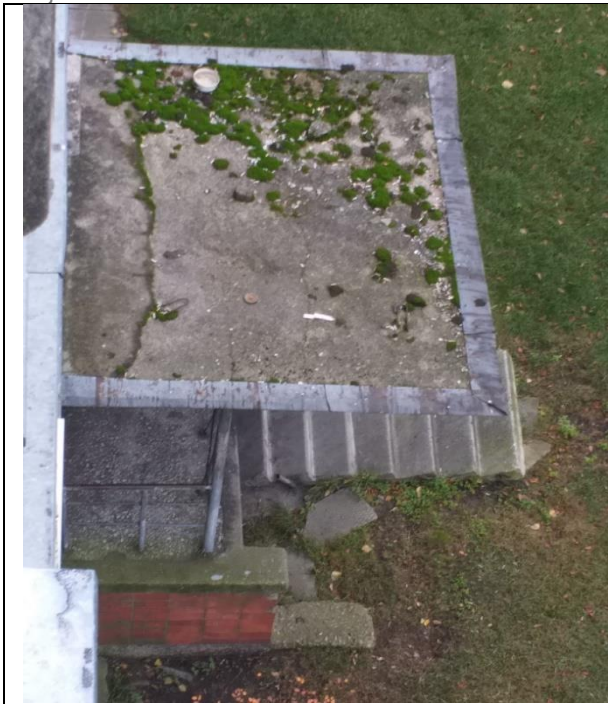
4.9.14.att. Rezerves ejas jumtiņa betona virsmas ar izdrupumiem, plaisām un apaugumu. Salacas iela 17.
