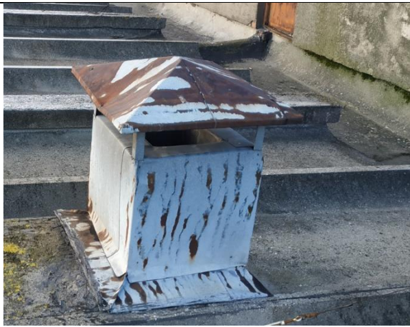
4.16.4. attēls. Vēdināšanas izvads caur atvērumu jumta pārseguma plātnē. Skārda elementi ir korodējuši.
