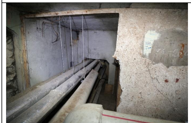
4.11.4. attēls. Ģipšbetona starpsienas neapmierinošā tehniskajā stāvoklī
