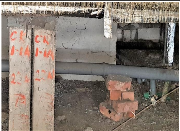
4.8.27.att. Cauruļvadi balstīti uz nestabiliem ķieģeļu stabiņiem. Rītupes iela 28, Rīga.
