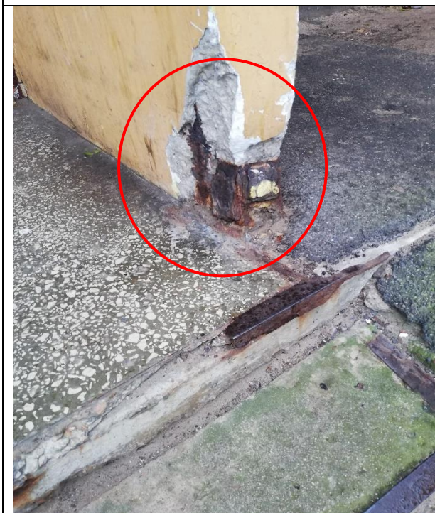
4.9.12.att. Nepieciešama atsegto metāla ieliekamo detaļu pretkorozijas apstrāde un aizdare ar remontjavu. Edžiņa gatve 1, Rīga.
