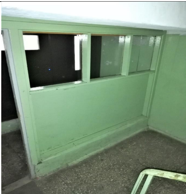
4.13.17. att. Kāpņu telpas vējtvera ailas aizpildījums ar koka rāmja konstrukciju un stiklojumu.
