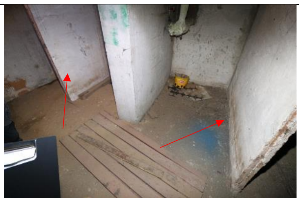
4.11.5. attēls. Ģipšbetona starpsienas neapmierinošā tehniskajā stāvoklī
