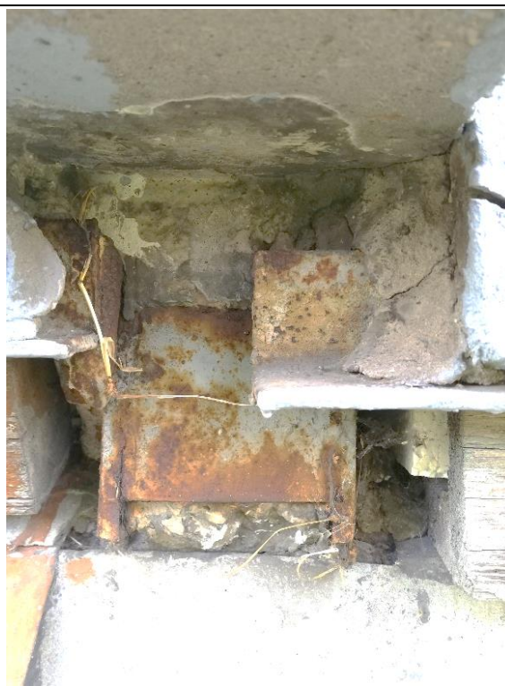
4.9.2.att. Lodžiju norobežojošos ekrānos ieliekamām detaļām nebūtiska korozija. Rītupes iela 28, Rīga.
