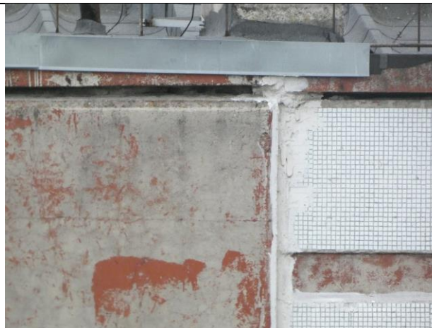
4.2.41. att. Kāpņu telpas frīzes panelis ar bojājumiem. Nav nodrošināts sadurvietas ar jumta plātņi, hermētiskums.
