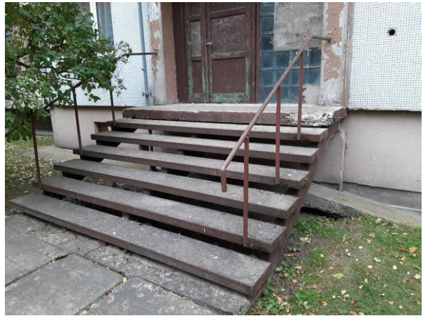
4.7.69.att. Ieejas kāpņu betona struktūra ir bojāta mitruma un sala iedarbībā
