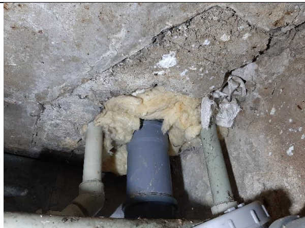
4.4.16. att. Inženiertīklu šķērsojums nav blīvi aizdarināts, iespējama dūmu caurlaidība
