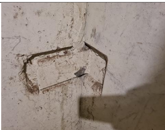
4.2.74.att. Metinājuma šuves atbilst Projektam, taču ieliekamās detaļas nav iebetonētas.
