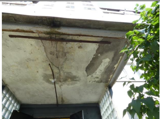
4.7.73. Jumtiņa plātnes betona struktūra ir bojāta mitruma un sala iedarbībā, atsegts un korodējis stiebrojums
