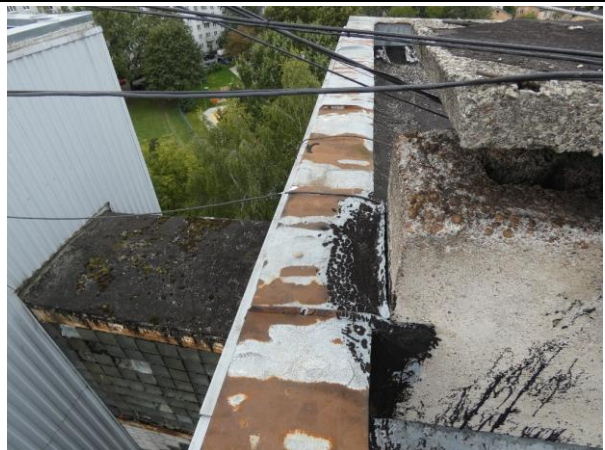
4.6.88.att. Skārda nosegelementi ar korozijas bojājumiem
