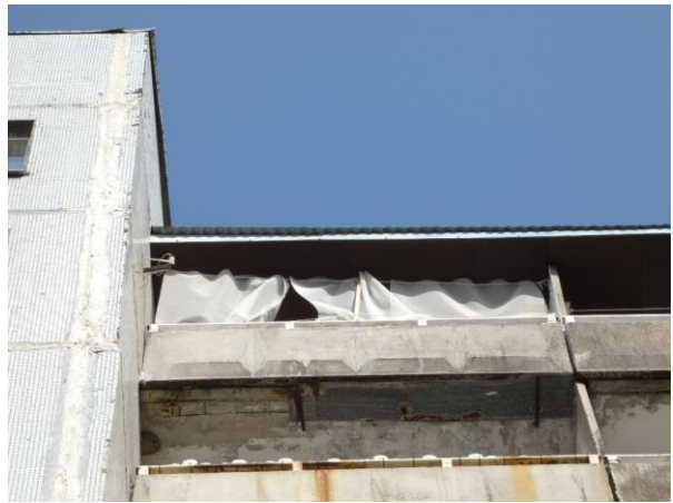
4.7.33.att. Lodžijas plātnes betona struktūra bojāta mitruma un sala iedarbībā, nokrišņiem ietekmējot plātnes virsmu.
