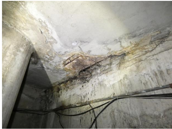
4.6.53.att. Tehniskās telpas (virs 9.stāva) savietotā jumta pārseguma plātne ar mitruma bojājumiem
