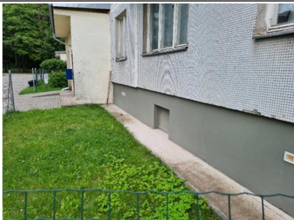
4.1.14. att. Ēkas aizsargapmale gar ēkas galveno fasādi, notecējumi no jumta skārda detaļām radīti bojājumi.
