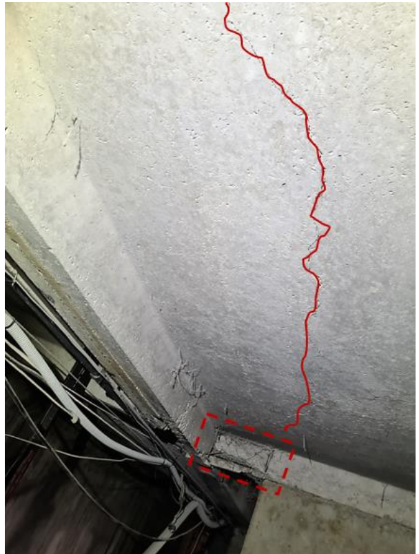
4.6.49.att. Jumta plātnei deformācijas plaisas, atsegts stiebrojums.
