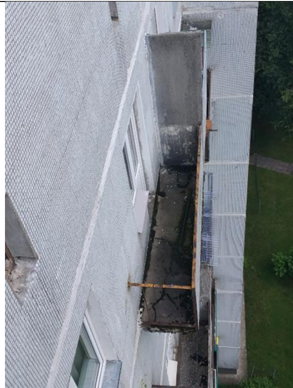
4.7.13. att. Balkona plātnes virsmas bojājumi, apaugums.
