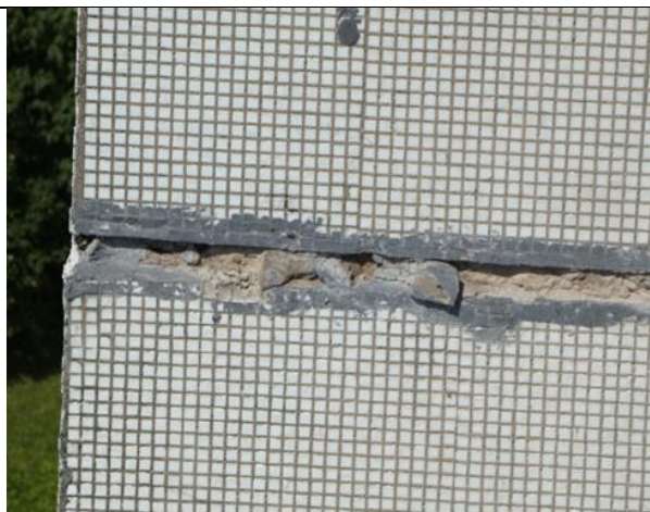
4.3.23.att. Horizontālā šuve nehermetizēta.
