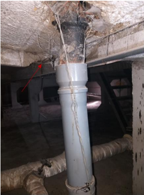
4.6.48.att. Jumta plātnes bojājums un mitruma infiltrācijas pazīmes savācējpiļtuves un cauruļvada vietā
