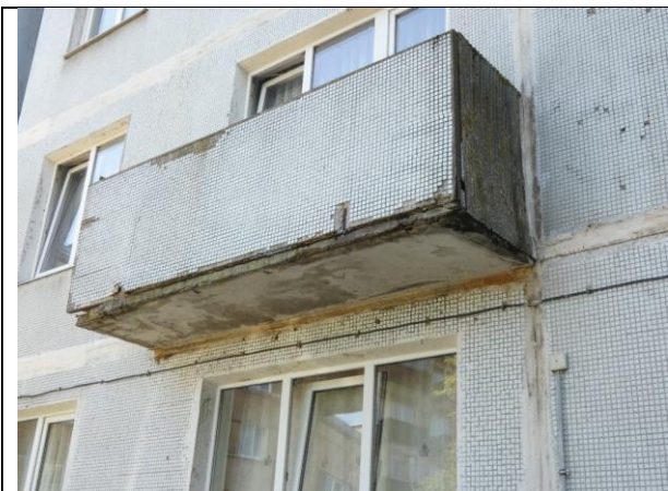
4.7.5. att. Balkonu plātnes un ekrāna betona struktūra ir bojāta mitruma un sala iedarbībā, atsegts, korodējis stiebrojums
