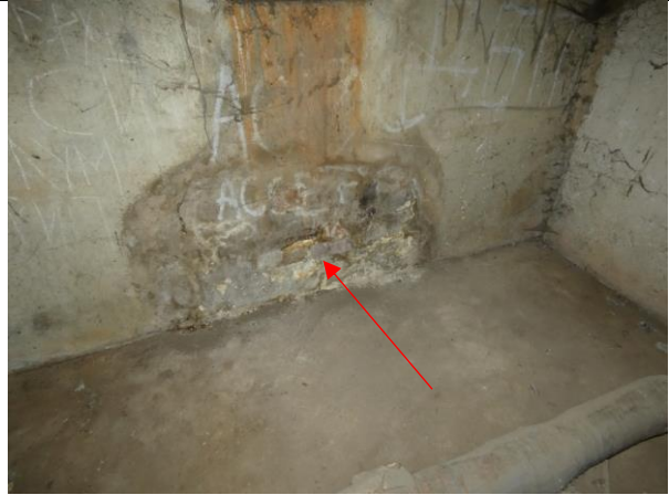
4.2.6. att. Aizmūrēts atvērums ārsienu panelī. Bojājumi ilgstošas mitruma infiltrācijas rezultātā.
