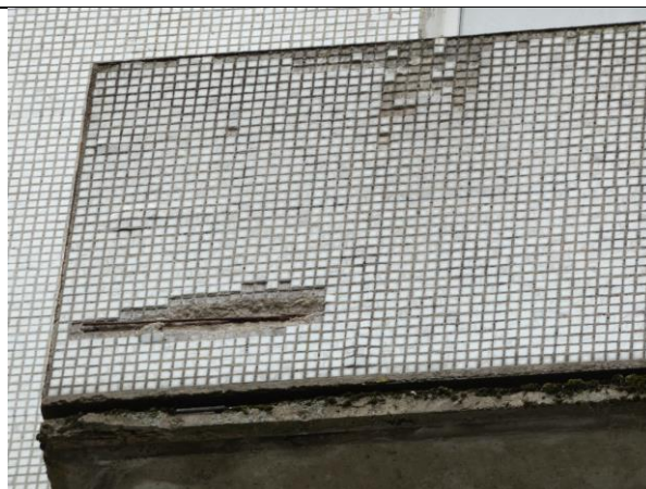
4.7.6. att. Dzelzsbetona plātnes un ekrāna pastiprināti bojājumi
