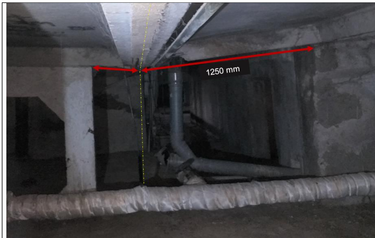
4.6.8.att. Jumta klāja plātnēm nav pietiekama balsta vieta gar ēkas garenasi. Notiek plātņu deformācijas.
