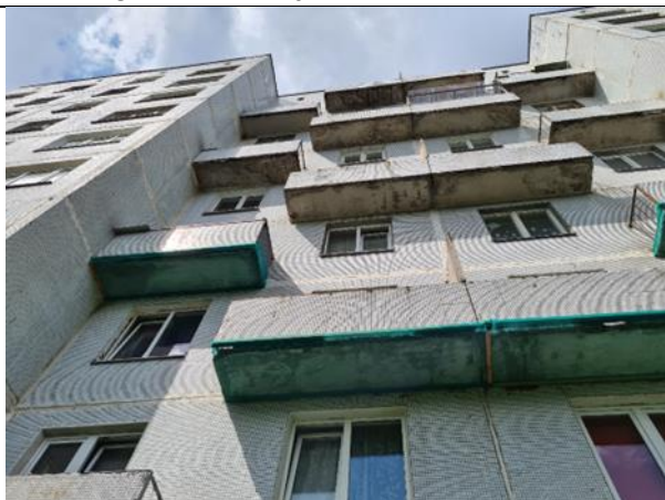
4.7.1.att. Balkoni, bojāti elementi.
