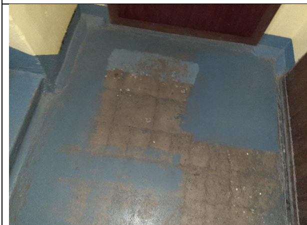
4.8.11. att. Neatbilstošs laukuma plātņu betona aizsargslānis, betona izdrupumi
