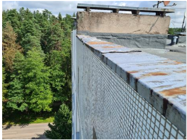
4.6.90. att. Skārda nosegdetaļu bojājumi un korozija, nekvalitatīvs savienojums, pirms nomaiņas.
