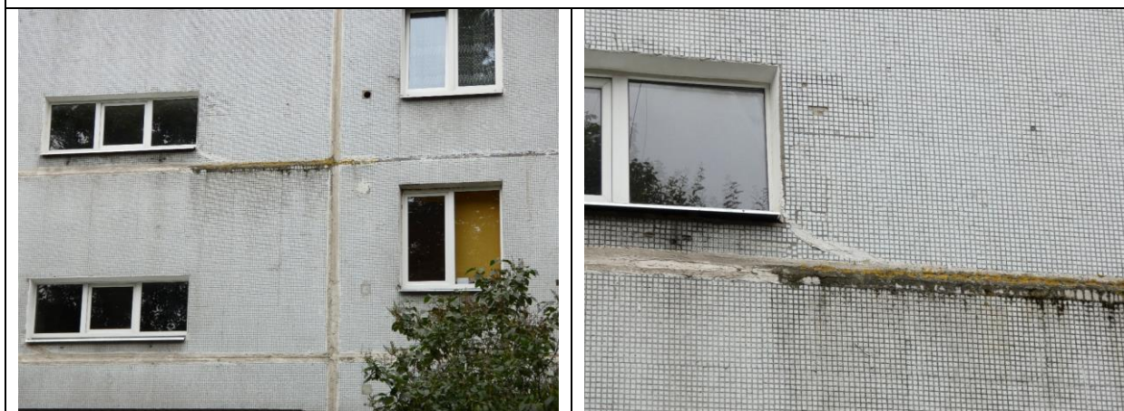
4.3.19. att., 4.3.20. att. Starppaneļu šuvju aizpildījums ar apaugumu. Veikta plaisu aizdare ar šuvju aizpildījuma mastiku.Slāvu iela 17, Rīga.
