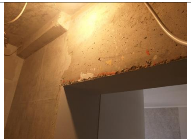
4.2.31. att. Iekšējā nesošā šķērssienu starp dzīvokļa gaiteni un istabu, gar sanitārtehnisko telpu - ventilācijas bloka panelis.
