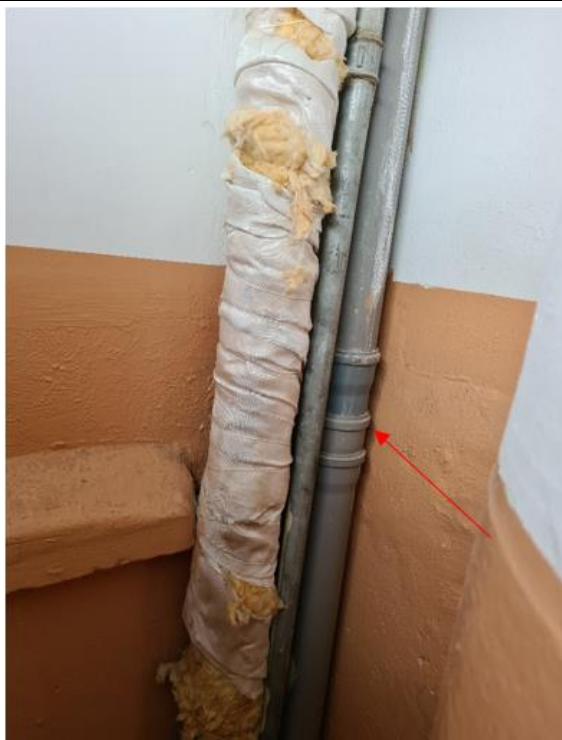
4.6.112. att. Jumta lietus ūdens novadīšanas stāvvads pvc, atkritumu vada telpā.
