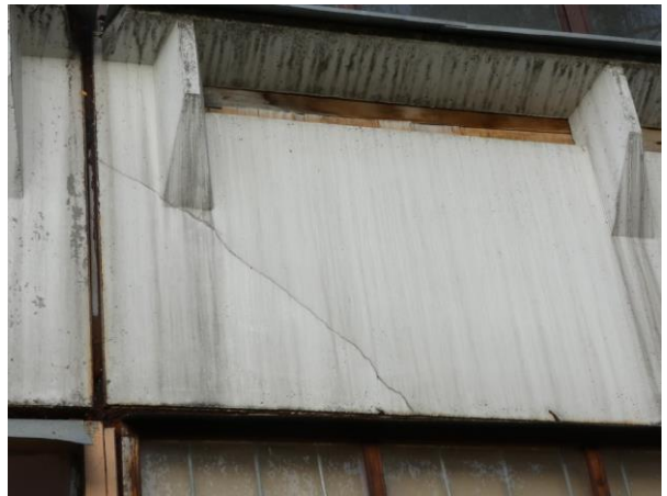
4.7.27.att. Lodžijas ekrāna betona plātne ar plaisām, marga ar apaugumu
