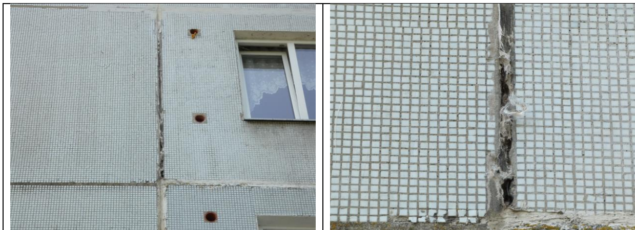
4.3.27. att. 4.3.28. att. Bojāts starppaneļu šuvju aizpildījums.
