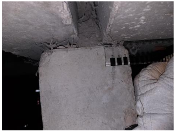
4.6.51.att. Jumta plātnes balsta vieta - 35 mm. Deformāciju pazīmes nav konstatētas.
