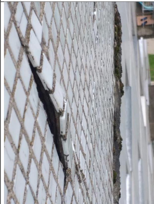
4.2.45. att. Ārsienas paneļa apdares bojājumi – mozaīkas bojājumi stiegrojuma korozijas dēļ.
