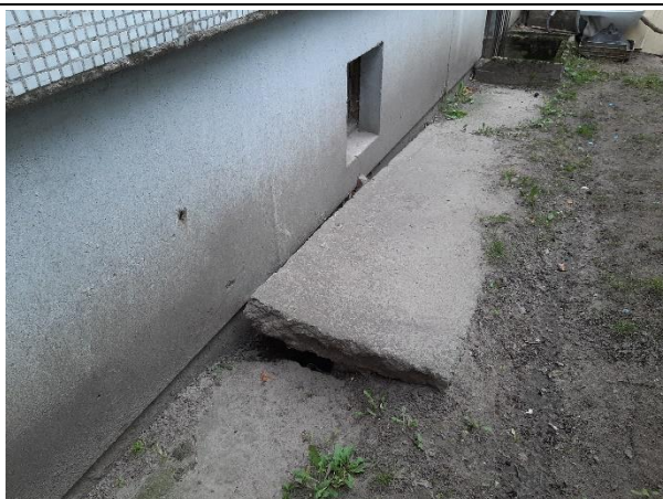
4.1.16. att. Ēkas aizsargapmales deformācija
