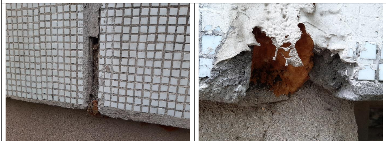
4.3.36., 4.3.37.att. Bojāts starppaneļu šuvju aizpildījums, ar montāžas putu pazīmēm.
