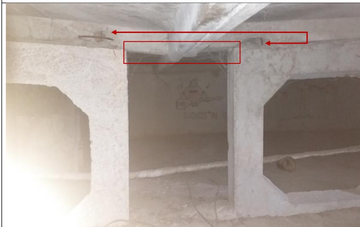
4.6.9.att. Jumta klāja dzelzsbetona plātņu malas (ēkas vidusdaļā) netiek balstītas uz jumta nesošajiem paneļiem visā garumā. Jumta plātņu bojājumi balsta vietās. Montāžas neprecizitātes.
