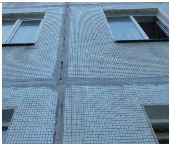
4.3.24.att. Nepilnīga vertikālās šuves aizdare.
