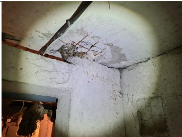
4.4.7. att. Pagraba pārseguma plātne ar izdrupumiem, atsegts, korodējis stiegrums
