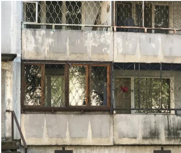
4.8.24.att. Lodžiju ekrāni ar vizuālajiem bojājumiem, metāla margu korozija. Patvaļīga būvniecība.
