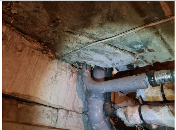
4.4.12. att. Pagraba pārseguma plātne. Nenoblīvētas inženierkomunikāciju šķērsojuma vietas.
