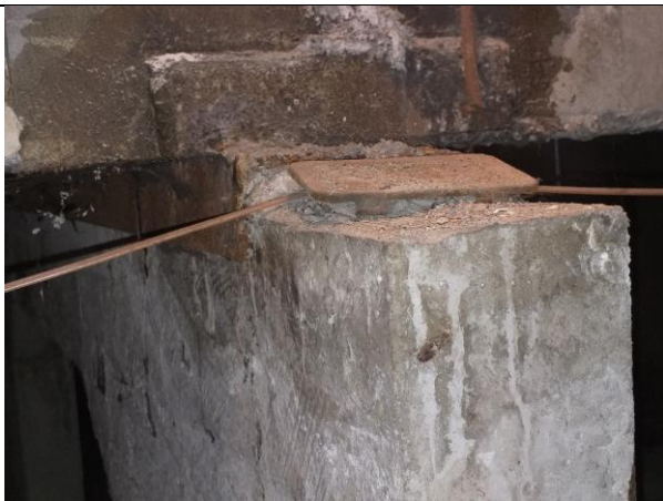
4.6.24.att. Teknes elementu balsta vietas montāža neatbilst Projekta norādēm
