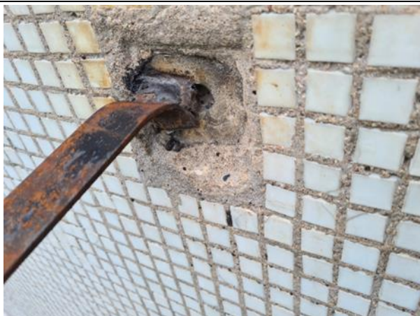
4.7.15. att. Balkona margu stiprinājumam metāla detaļu korozija.
