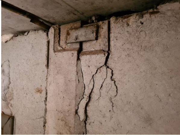
4.2.9. att. Atdalījusies betona aizsargkārtā, būvniecības laikā ieliekamo detaļu cementa javas aizsargkārtā nav ierīkota
