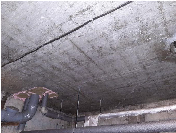
4.4.11. att. Neatbilstošs betona aizsargslānis, stiegrojuma korozija, nebūtiskas plaisas, Keldiša iela 15, Rīga
