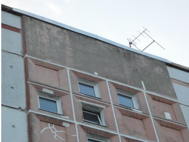
4.2.38. att. Kāpņu telpas frīzes panelis ar bojājumiem, skārda nosegelementiem nav pietiekamais lāsenis.
