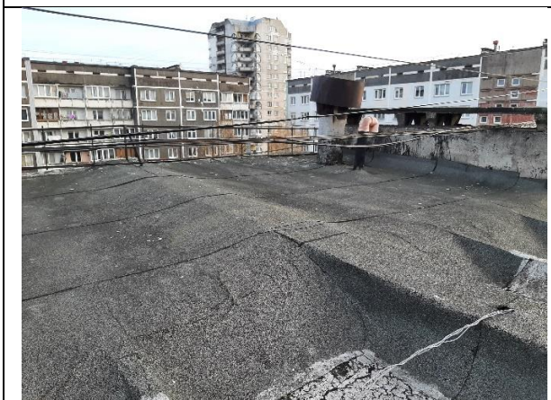
4.3.52. att. Kāpņu telpas savietotā jumta siltumizolācija ierīkota daļējā apjomā.
