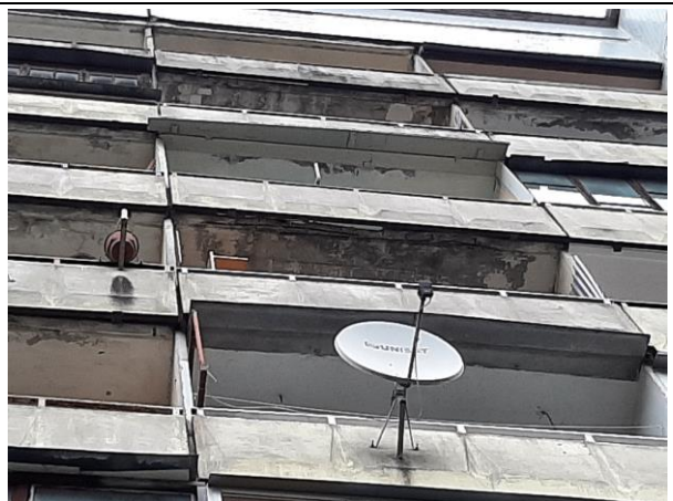
4.7.29.att. Lodžijas plātnes betona struktūra ir bojāta mitruma un sala iedarbībā
