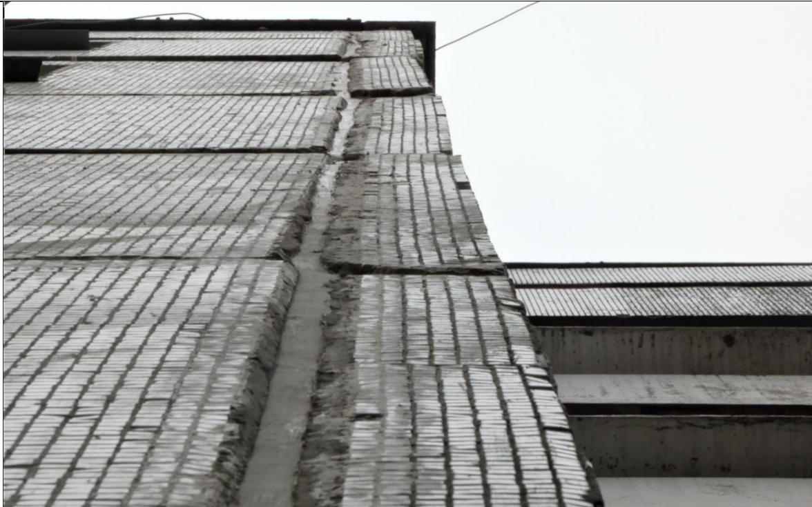
4.2.88.att., 4.2.9.att., 4.2.90.att. Paneļu montāža veikta ar nobīdēm no vertikālās ass.
