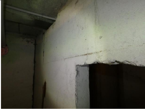
4.2.15.att. Šķērssienu panelis 160 mm. Atsegts stiegrojums, neatbilstoša aizsargkārtā
