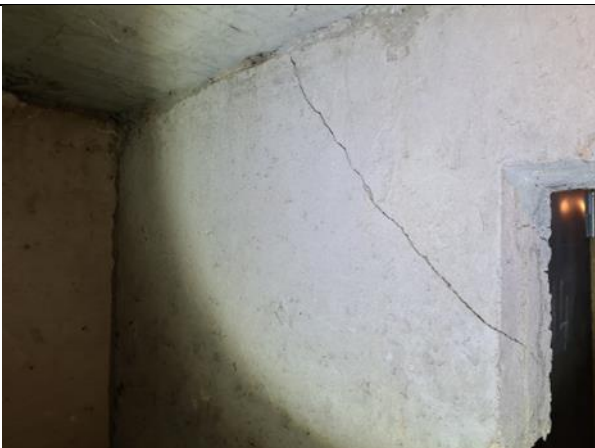
4.2.7. att. Plaisa šķērssienu panelī pagraba stāvā. Visticamāk, transportēšanas laikā, dinamika nav novērota.
