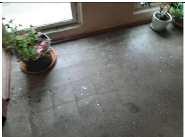
4.8.12.att. Neatbilstošs kāpņu laukuma betona aizsargslānis
