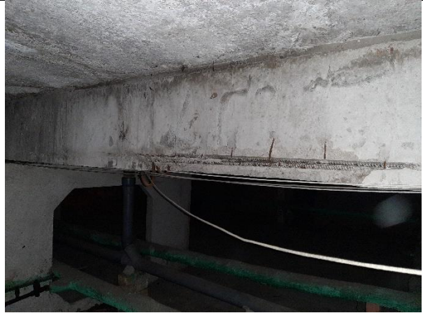
4.6.17.att. Atsegts un korodējis teknes elementa stiebrojums
