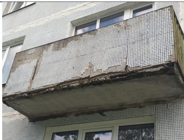
4.7.2. att. Balkonam progresējoši ekrāna un plātnes bojājumi, atsegts stiegrojums, apdares bojājumi.
