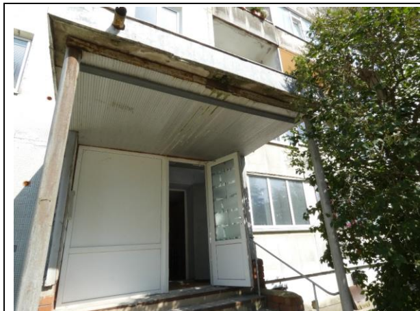
4.7.74.att. Ieejas mezgla jumtiņa izdrupumi, stiegrojuma un ieliekamo detaļu atsegumi un korozija.
