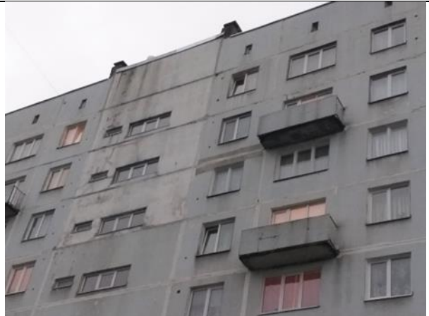
4.2.49. att. Bojājumi uz ārsienas paneļiem - skārda nosegelementi ierīkoti ar defektiem, DA fasāde, 2.kāpņu telpa
