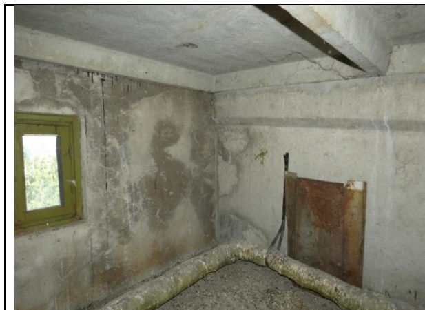
4.2.61. att. Tīklveida plaisas un mitruma bojājumi ārsienu frīzes paneļos
