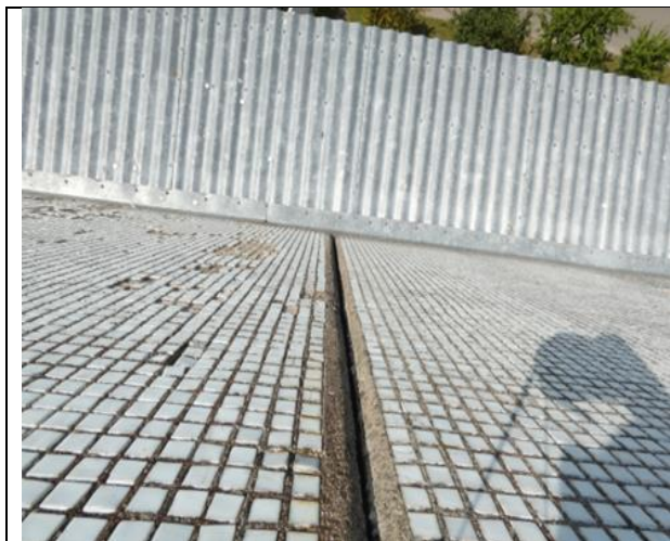
4.3.21.att. Vertikālā saduršuve nav hermetizēta.
