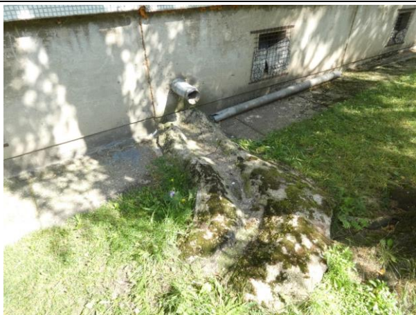
4.6.124. att. Lietus ūdens netiek novadīts pilsētas centralizētajā lietus ūdens kanalizācijas sistēmā. Vizuāli konstatējams, ka blakus esošais zālājs un ietves ir augstāki par ēkas aizsargapmali, līdz ar to lietus ūdens infiltrējas ēkas pamatu tuvumā.
