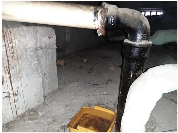
4.6.115. att. Čuguna stāvvadi, saglabājušies no ēkas celtniecības laika, mitruma noplūde
