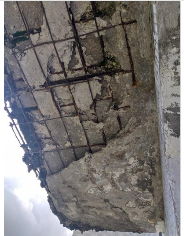
4.7.14. att. Balkona plātnes pārmitrināšana, botona izdrupumi, slāņošanās, izsālījumi, neatgriezeniski bojāts stiegrojuma siets.
