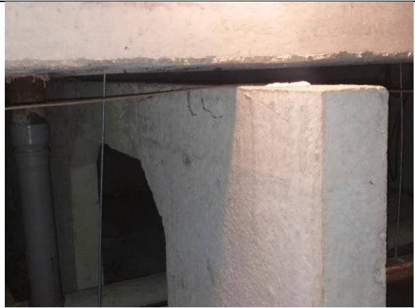
4.6.23.att. Teknes elements netiek balstīts uz starpbalsta jumta plātņu nesošā paneļa - sijas ПК-17А-1 virsmas un montēts bez javas kārtas neatbilstoši Projekta risinājumiem.
