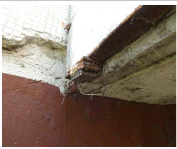
4.7.35.att. Lodžijas ekrāna rāmis korodējis, neatbilstošs stiprinājums.
