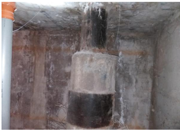
4.9.3. att. Atkritumu vada ventilācijas izvads ar nehermētiskuma pazīmēm pieslēguma vietā.
