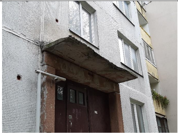
4.7.71. Jumtiņa plātnes betona struktūra ir bojāta mitruma un sala iedarbībā, atsegts un korodējis stiebrojums
