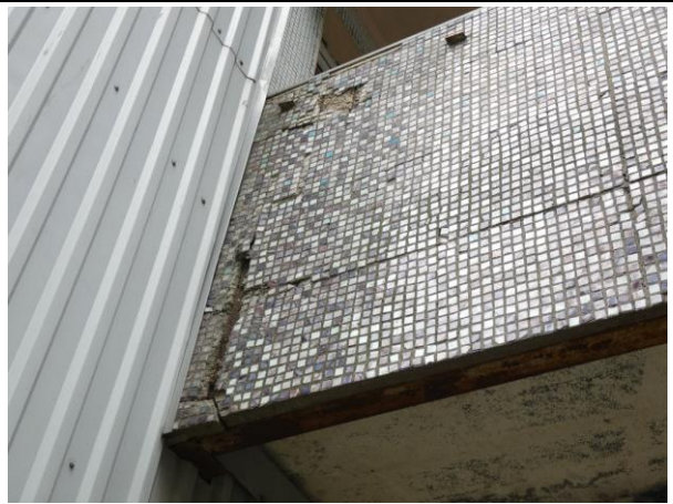
4.7.23. att. Dzelzsbetona ekrāna betona struktūra ir bojāta mitruma un sala iedarbībā, atsegts, korodējis stiegrojums
