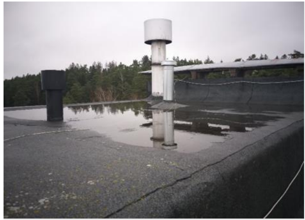
4.6.84.att. Nokrišņu paliekas uz jumta seguma virs kāpņu telpas.
