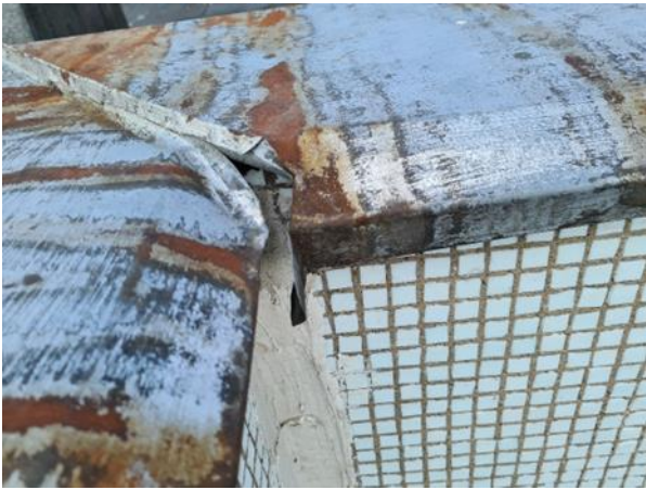
4.6.89.att. Skārda nosegdetaļu bojājumi un korozija pirms nomaiņas
