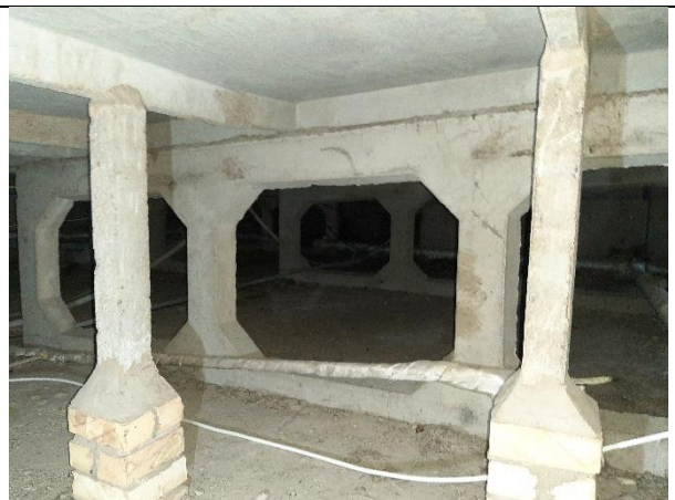
4.6.15.att. Jumta klāja plātņu deformācija, patvaļīgi ierīkoti balsti
