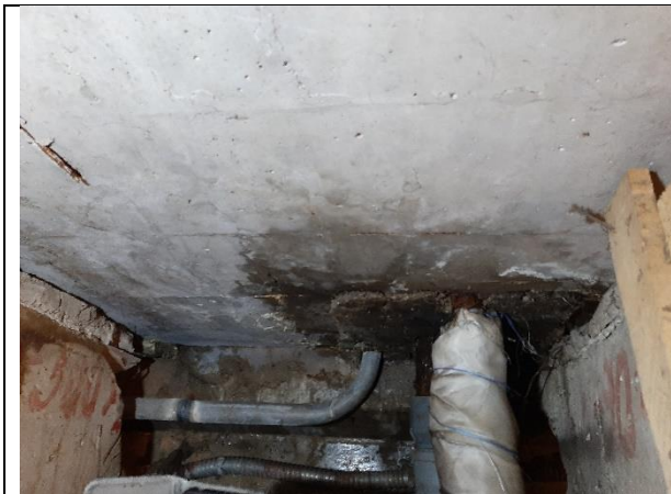
4.4.15. att. Inženiertīklu noplūžu rezultātā bojāta pārseguma plātnes struktūra
