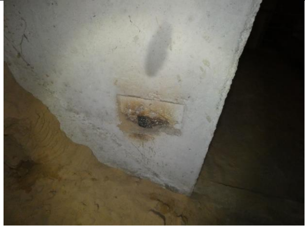
4.2.16.att. Šķērssienu panelis 160 mm. Ieliekamās detaļās korozija, cementa javas aizsargslānis nav ierīkots
