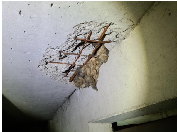
4.4.8. att. Iespējams, mehāniski radīts bojājums. Atsegts, korodējis stiegrums.
