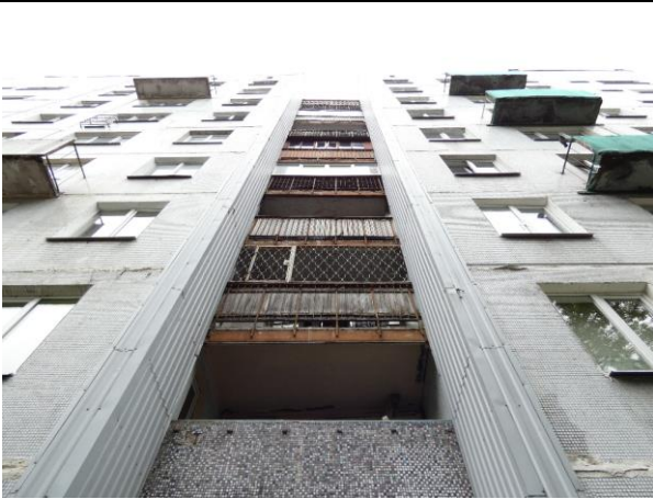
4.7.22.att. Ēkai izbūvētas ārtelpas, kas bloķējas ar blakus esošo ēku (Slāvu iela 15) – pēc lietošanas veida, ārtelpas faktiski izmantojamas kā lodžijas. Norobežojošie metāla elementi ar korozijas bojājumiem.
