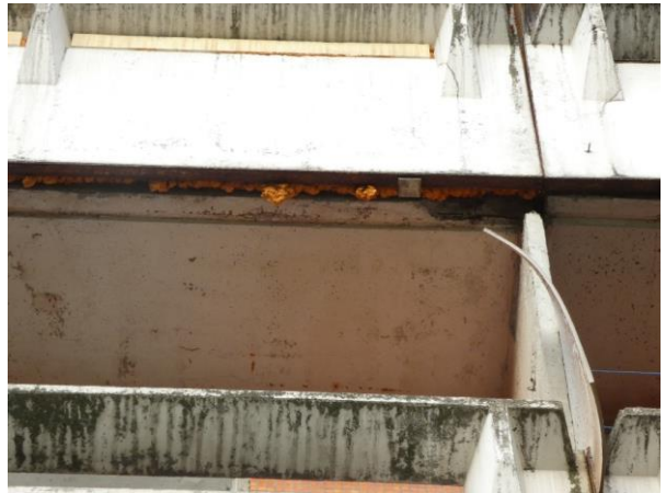
4.7.25.att. Lodžijas ekrāna betona marga ar apaugumu un mikroplaisām
