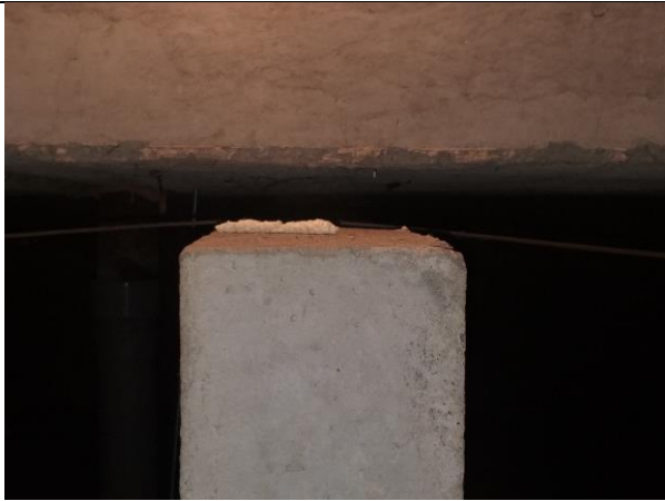
4.6.22.att. Teknes elements netiek balstīts uz starpbalsta jumta plātņu nesošā paneļa - sijas ПК-17А-1 virsmas un montēts bez javas kārtas neatbilstoši Projekta risinājumiem.
