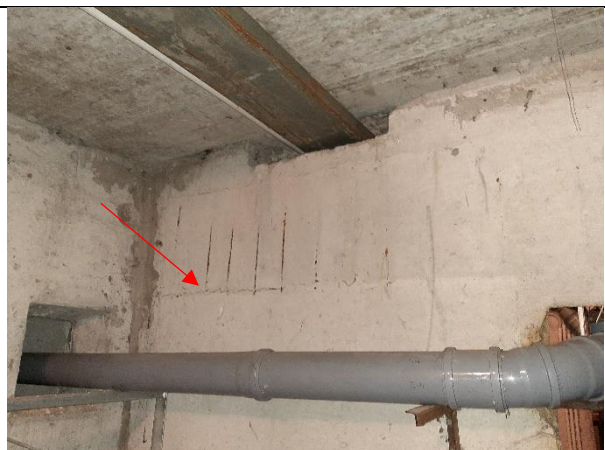
4.2.20. att. Neatbilstošs aizsargslānis, atsegts stiegrojums, stiegrojuma korozija
