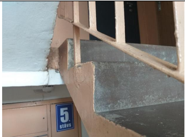
4.8.6.att. Montāžas būvdarbu defekts – pēdējam pakāpienam jābūt vienā līmenī ar laukumu. Balsta vieta bez bojājumu pazīmēm.
