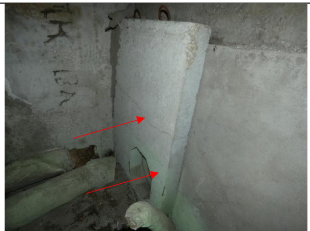
4.6.21.att. Horizontāla plaisa panelī CK-1, visdrīzāk, radusies būvdarbu laikā vai transportējot
