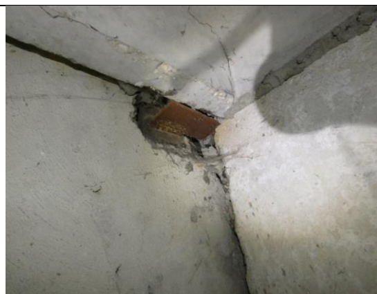
4.2.77.att. Jumta klāja plātnei jābalstās uz plauktiņa. Plauktiņa virsma korodējusi. Plātnes kakta virsmas plaisa. Metinājuma šuves katete atbilstoša.
