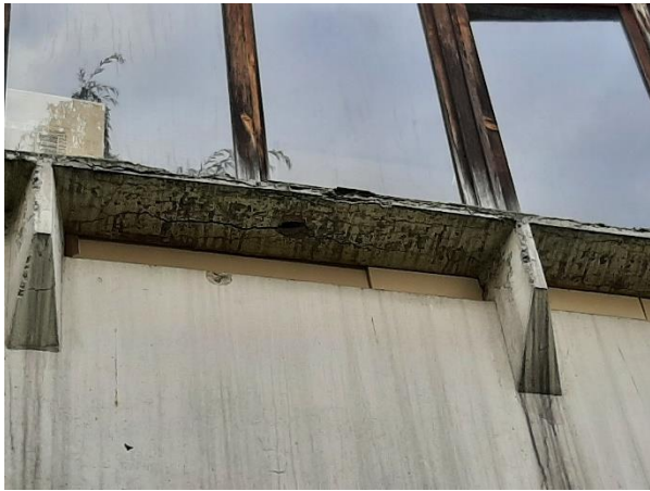
4.7.30.att. Lodžijas margu betona struktūra ir bojāta mitruma un sala iedarbībā
