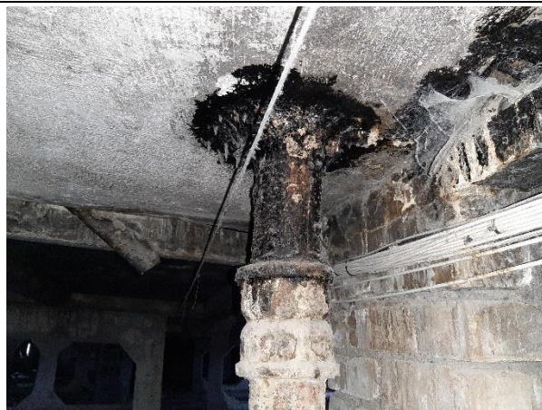
4.6.121. att. Jumta lietus ūdens novadīšanas stāvvads čuguna, saglabājies no ēkas būvniecības laika
