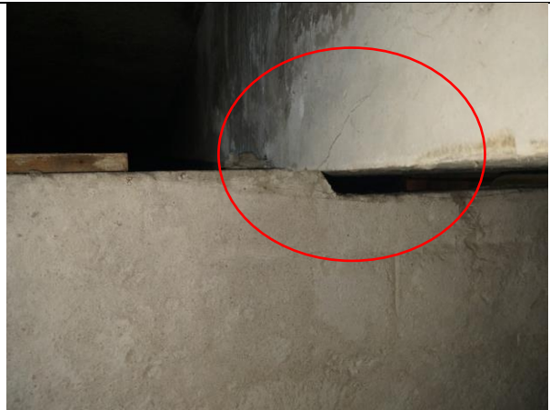
4.6.19.att. Teknes elements nav balstīts uz paneļa PK-17A-1 virsmas. Spriegumu rezultātā tekne radusies plaisa.
