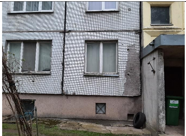
4.2.51. att. Ārsienas paneļi ar flīžu apdares bojājumiem
