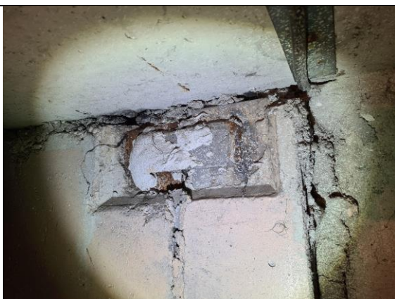
4.2.76. att. Būvniecības laikā cementa javas aizsargkārtā nav ierīkota
