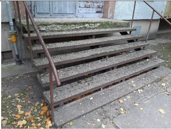
4.7.70. Ieejas kāpņu betona struktūra ir bojāta mitruma un sala iedarbībā, atsegts un korodējis stiebrojums
