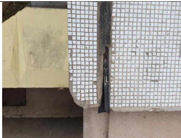
4.3.5.att. Starppaneļu vertikālā šuve ar poroizola un cementa javas blīvējumu. Zem poroizola uzstādīta neoprēna gumijas lēta.
