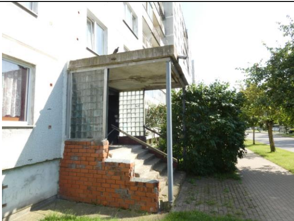
4.7.72. Ieejas kāpņu betona struktūra ir bojāta mitruma un sala iedarbībā, atsegts un korodējis stiebrojums
