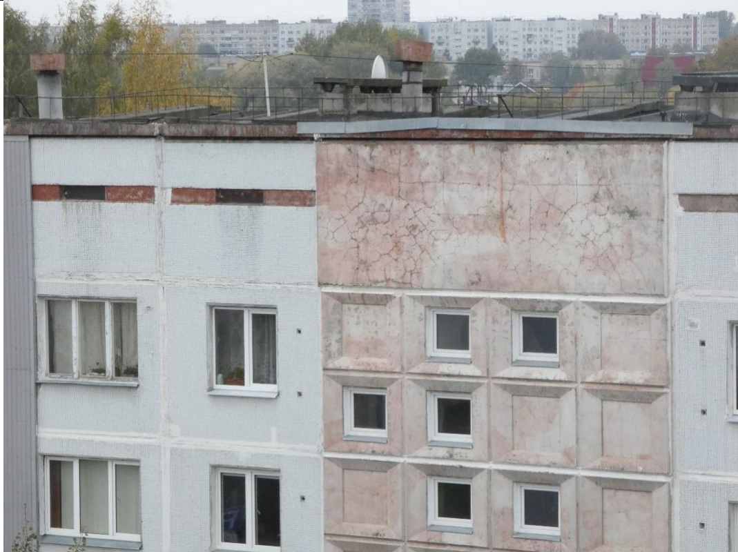
4.2.37. att. Kāpņu telpas frīzes panelis ar virsmas bojājumiem. Jumta plātnēm nav pārkare un sadurvietas hermētiskums, skārda nosegelementi ar defektiem.
