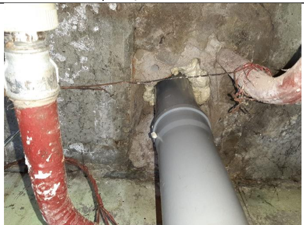
4.4.14. att. Inženiertīklu šķērsojumi aizdarināti ar neatbilstošas ugunsizturības klases būvizstrādājumiem
