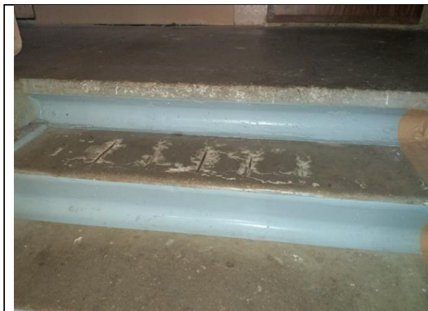
4.8.13.att. Neatbilstošs laukuma plātņu betona aizsargslānis, betona izdrupumi
