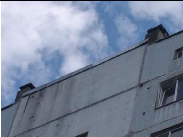
4.2.48. att. Notecējumi uz ārsienas paneļa - skārda nosegelementi ierīkoti ar defektiem, DA fasāde, 1.kāpņu telpa
