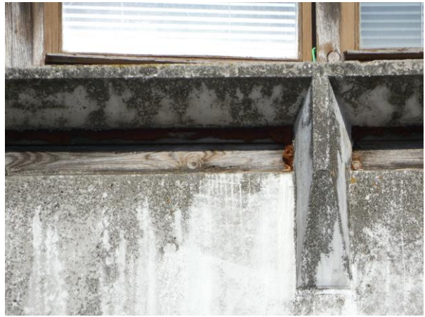
4.7.31.att. Lodžijas margu betona struktūra ir bojāta mitruma un sala iedarbībā
