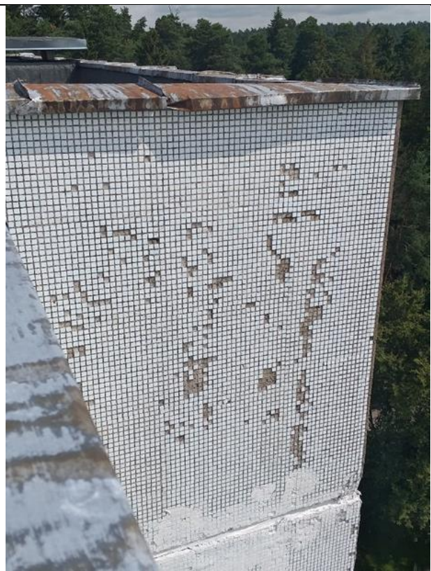
4.2.46. att. Mozaīkas izdrupumi ārsienas paneļos, veidojušies atmosfēras nokrišņu ietekmē. Korodējuši elementi.
