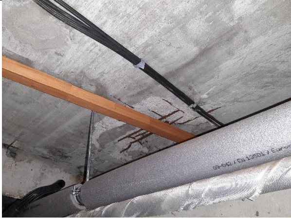
4.4.7. att. Atsegts un korodējis stiegrojums
