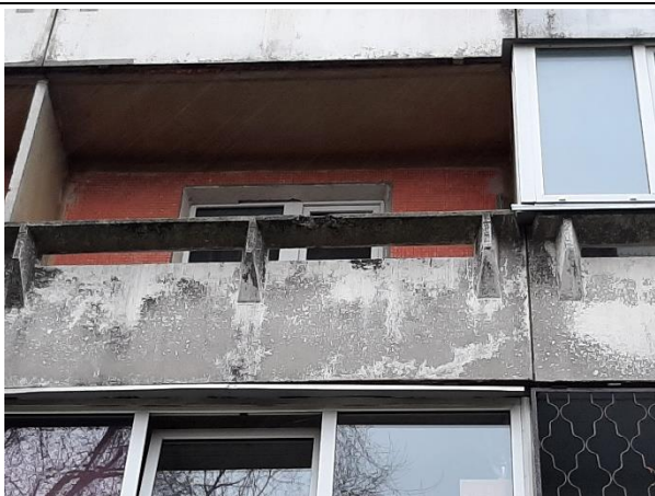
4.7.28.att. Lodžijas margu betona struktūra lokāli bojāta
