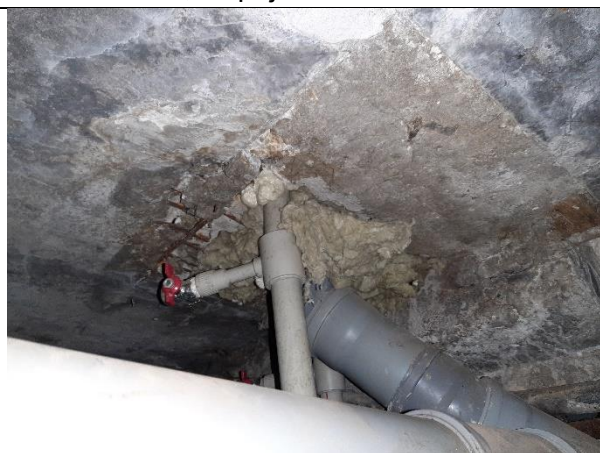
4.4.18. att. Inženiertīklu šķērsojumi nav aizdarināti ar atbilstošas ugunsizturības klases būvizstrādājumiem, atsegts un korodējis stiegrojums
