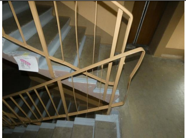
4.8.8.att. Kāpņu laukumam nepietiekams stiegrojuma aizsargslānis, zuduši vinila nosegelementi
