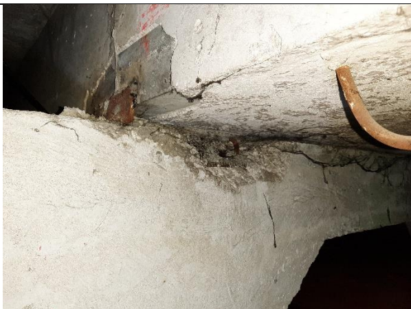
4.6.20.att. Jumta paneļa bojājumi teknes basta vietā
