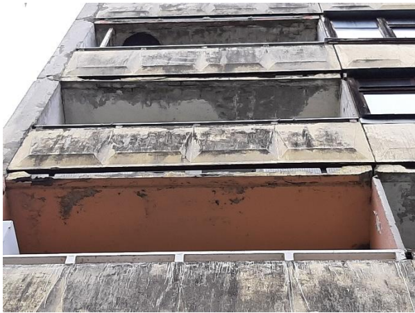
4.7.32.att. Lodžiju elementu bojājumi mitruma un sala iedarbībā
