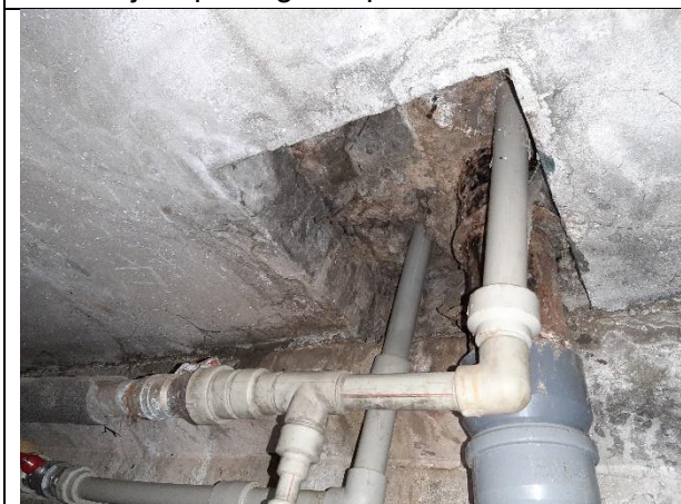
4.4.17. att. Inženiertīklu noplūžu rezultātā bojāta pārseguma plātnes struktūra
