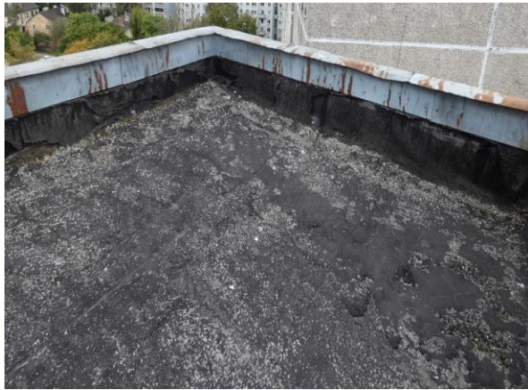
4.6.83.att. Jumta segums fiziski un morāli nolietojies, nepieciešama tā atjaunošana visā platībā
