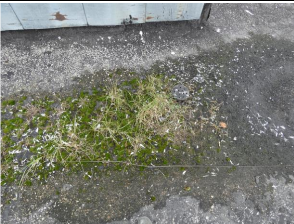
4.6.87.att. Apaugums uz jumta seguma
