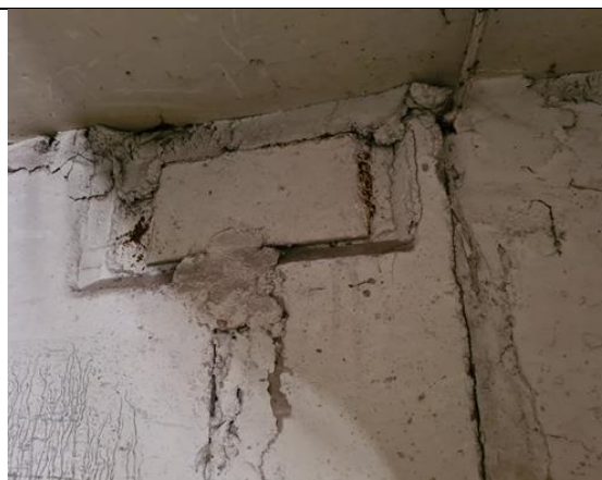
4.2.75.att. Metinājuma šuves atbilst Projektam. Šuvju aizdares zemas kvalitātes būvdarbu izpildījums.
