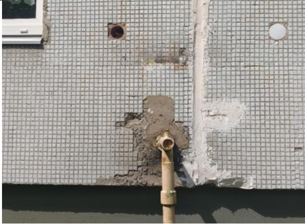
4.2.46. att. Mehāniskie bojājumi ārsienas paneļu stūros transportēšanas laikā un gāzes ievada vietā
