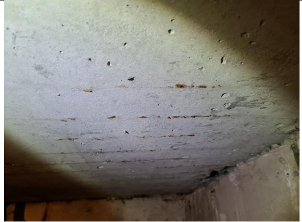
4.4.10. att. Pagraba pārseguma plātne ar neatbilstošu betona aizsargkārtu, redzams korodējis stiegrojums
