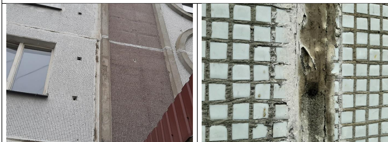
4.3.31. att., 4.3.32.att. Bojāts starppaneļu šuvju aizpildījums
