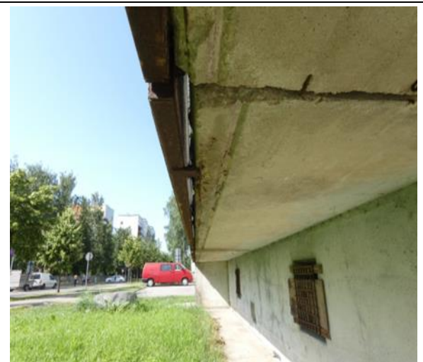
4.7.34.att. Divu lodžiju grīdas plātņu sadures vieta. Stiegrojums atsegts. Lodžijas ekrāna
