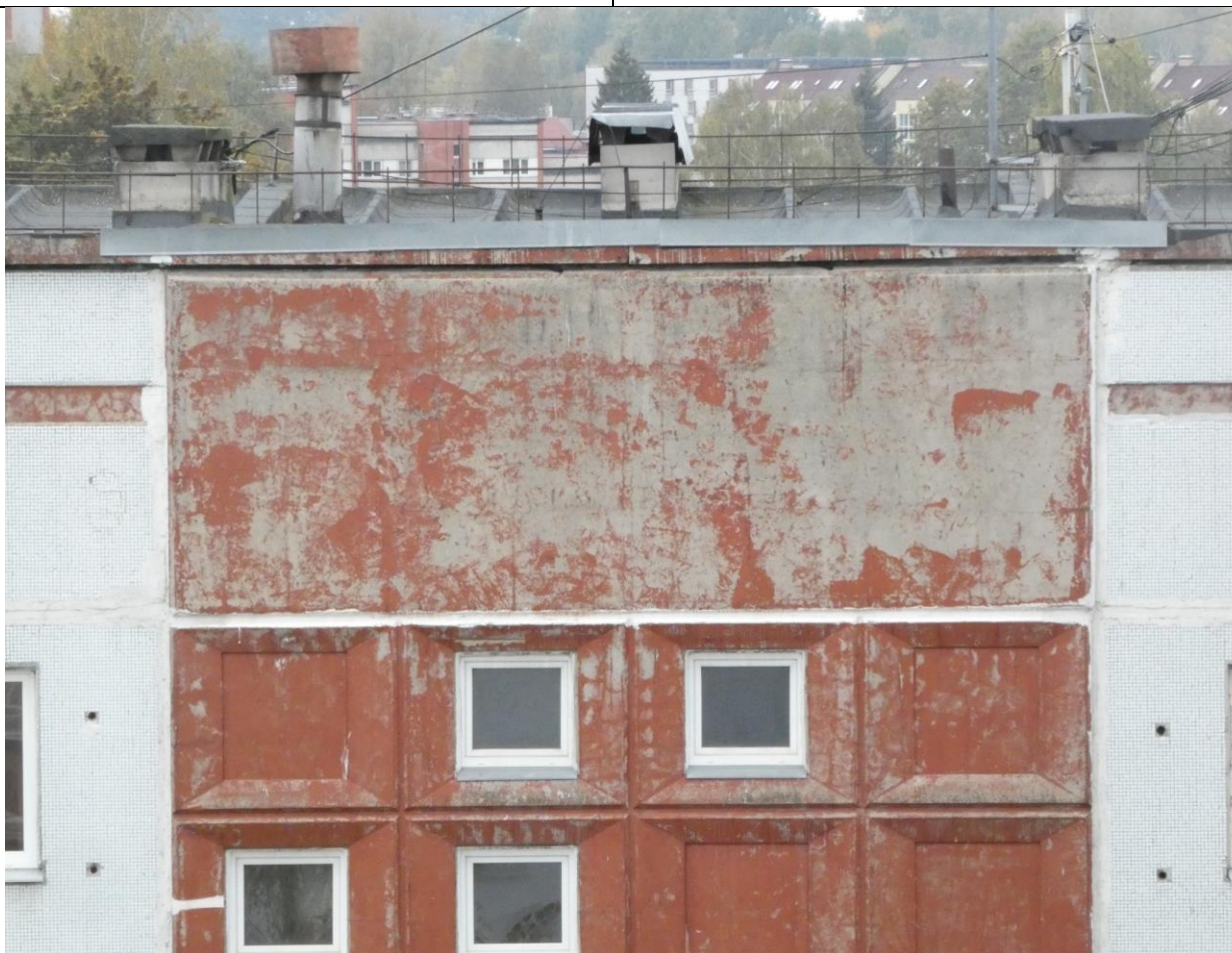
4.2.42. att. Kāpņu telpas frīzes panelis ar bojājumiem. Nav nodrošināts sadurvietas ar jumta plātņi, hermētiskums un jumta plātņu pārkare.
