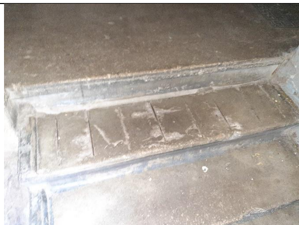
4.8.14.att. Neatbilstošs laukuma plātņu betona aizsargslānis, betona izdrupumi
