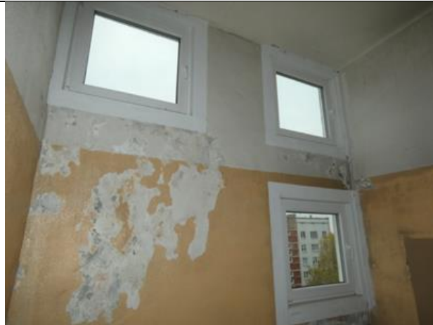
4.2.39. att. Kāpņu telpas frīzes panelis ar ilgstoša mitruma ietekmes bojājumiem, kāpņu telpā.
