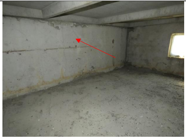
4.6.13.att. Gala sienas panelis ПК-22, uz kura balstītas jumta klāja dzelzsbetona plātnes. Paneļa virsma ar tīklveida un vertikālām plaisām.
