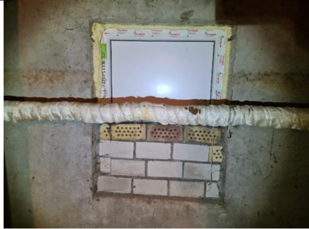
4.2.10. att. Loga aila pagraba panelī daļēji aizmūrēta ēkas ekspluatācijas laikā
