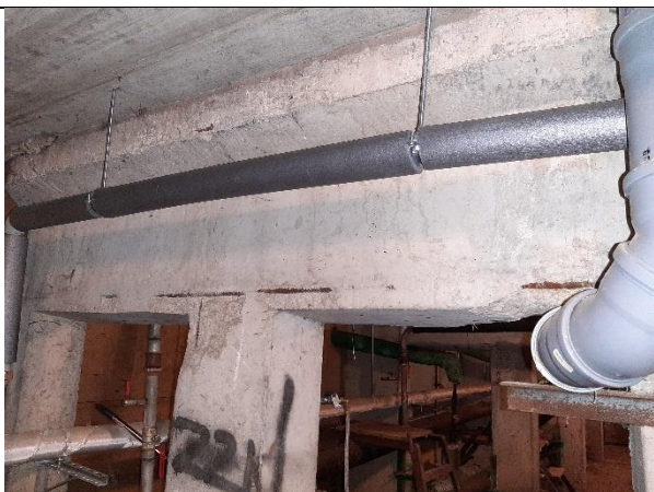
4.2.19. att. Neatbilstošs aizsargslānis, atsegts stiegrojums, stiegrojuma korozija
