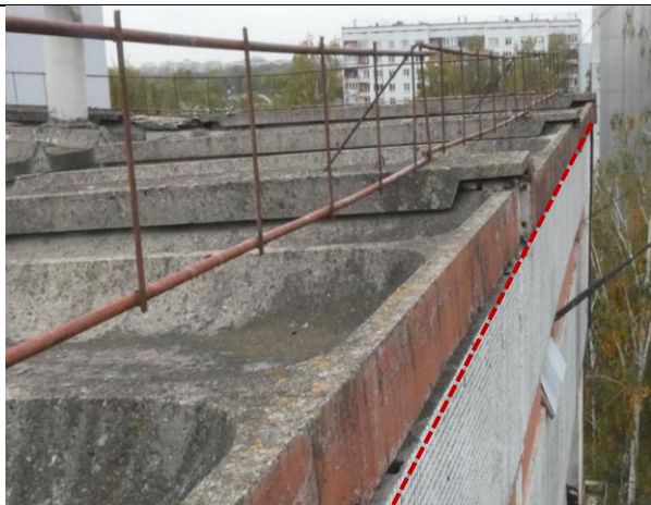
4.2.40. att. Frīzes paneļu aizsardzībai nav veidota jumta plātņu pārkare - nav nodrošināts sadurvietas ar jumta plātņi, hermētiskums.
