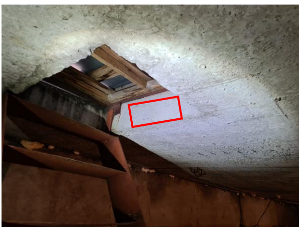
2.5.att. Jumta klāja plātne КПН 52-32-6. Rudens iela 4, Rīga. Pēc Projekta betona marka M400 (C25/30).
