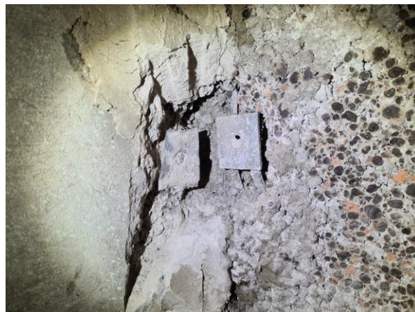
1.2.att. Atsegumā konstatētas ielikamās detaļas 80x80x8 mm, kas piemetinātas pie diviem stiegru d12 izlaidumiem. Paneļu ielikamo detaļu savienojuma elements nav uzstādīts .
