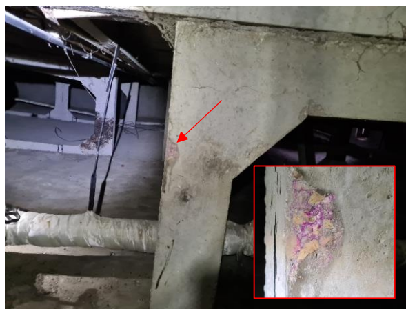
3.8.att. Ieejas mezgla jumtiņa dzelzsbetona plātne. Zilokalnu pr. 24, Ogre. Betona struktūra daļēji karbonizējusies.
