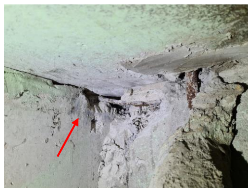
4.2.att. Atsegumā konstatēta šķērssienu paneļa ieliekamā detaļa 80x80x8 mm, kas piemetināta pie diviem stiegru d12 izlaidumiem.
