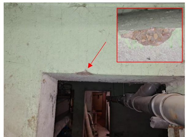
3.6.att. Ieejas mezgla jumtiņa dzelzsbetona plātne. Karbonizētais slānis vairāk par 10 mm. Zilokalnu prospekts 24, Ogre.
