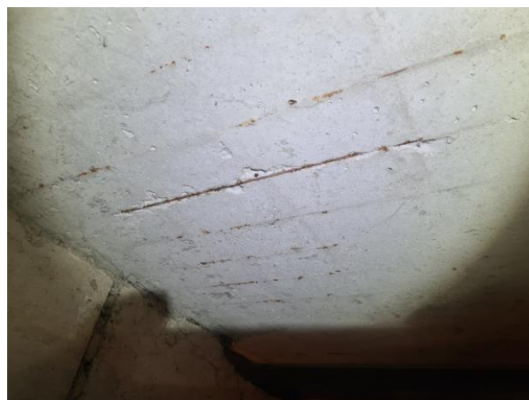
9.12.att. Atseguma 9.3 kopskats. Siets d5, ar soli 100 mm šķērsvirzienā un 200 mm garenvirzienā – atbilstoši Projektam. Plātnei neatbilstoša betona aizsargkārtā – notiek stieģrojuma korozija.
