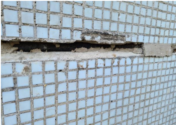
4.1.att. Keramzītbetona paneļu šuves atsegums Enerģētiķu iela 6, Salaspils. No ēkas iekšpuses šuve aizpildīta ar cementa javu, tad uzstādīts blīvējuma elements d30 mm (poroizols) un no ārpuses šuve aizdarīta ar cementa javu.
