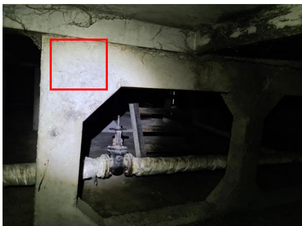
2.21.att. Jumta klāja plātne PK-17. Zilokalnu pr. 24, Ogre. Pēc Projekta betona marka M200 (C12/15).
