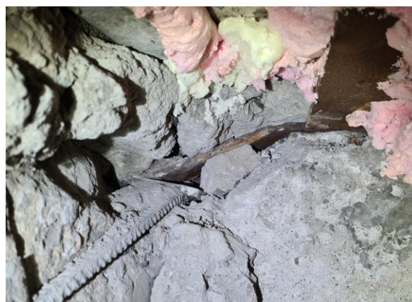
12.5.att. Atseguma vieta 12.2. tuvplānā. Pretkorozijas apstrāde nav veikta vai ir veikta daļēji.
