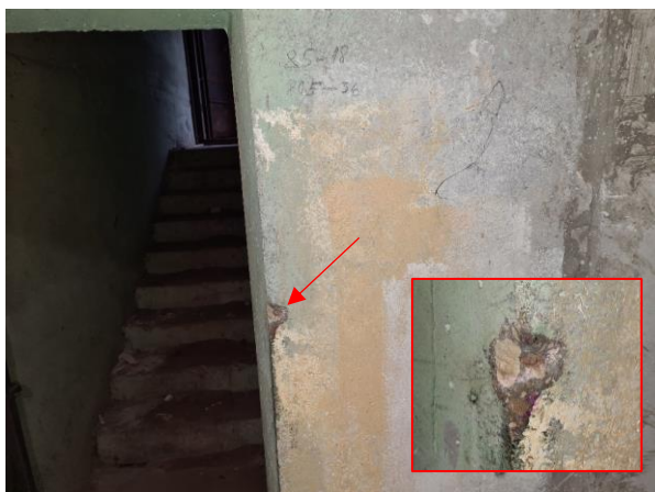
3.7.att. Dzelzsbetona pārsedze. Karbonizētais slānis vairāk par 10 mm. Zilokalnu prospekts 24, Ogre.
