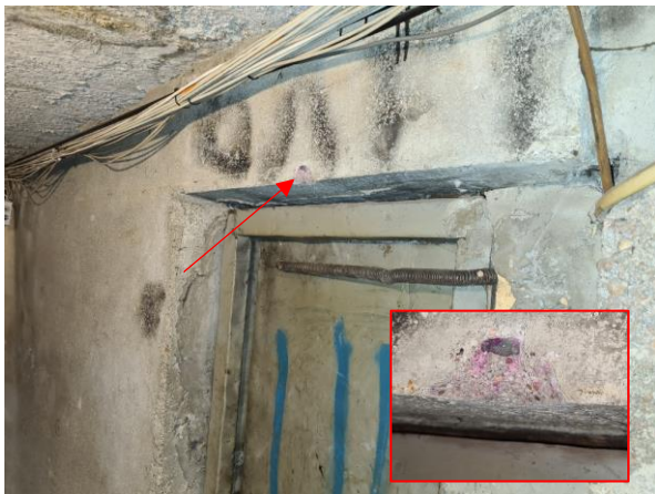
3.3.att. Dzelzsbetona pārsedze. Betona struktūra daļēji karbonizējusies. Rudens iela 4, Rīga.
