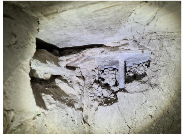
2.2.att. Atsegumā konstatētas ieliekamās detaļas 80x80x8 mm, kas piemetinātas pie diviem stiegru d12 izlaidumiem. Paneļu ieliekamo detaļu savienojums ierīkots piemetinot loksni 60x80x8 mm.
