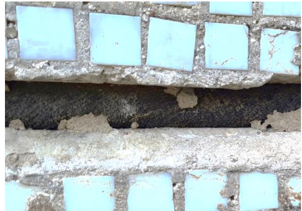
4.2.att. Starppaneļu blīvējuma materiāls (poroizols) d30 mm. Cementa javas aizpildījums ekspluatācijas laikā zaudējis saķeri ar paneļu virsmu un daudzās vietās plaisā un izdrūp.
