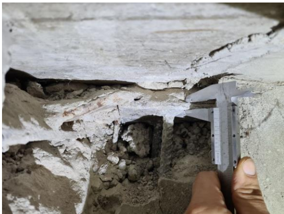
2.3.att. Ieliekamās detaļas 8 mm biezumā. Ieliekamās detaļas apstrādātas ar auksto cinku, korozijas pazīmes nav konstatētas. Metinājuma šuves ierīkotas nekvalitatīvi.
