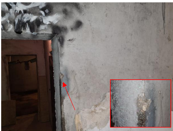
3.5.att. Dzelzsbetona pārsedze. Karbonizētais slānis vairāk par 10 mm. Zilokalnu prospekts 24, Ogre.
