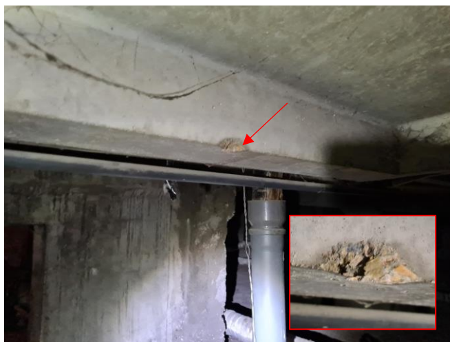
3.9.att. Dzelzsbetona pārsedze. Karbonizētais slānis lielāks par 10 mm. Zilokalnu prospekts 24, Ogre.
