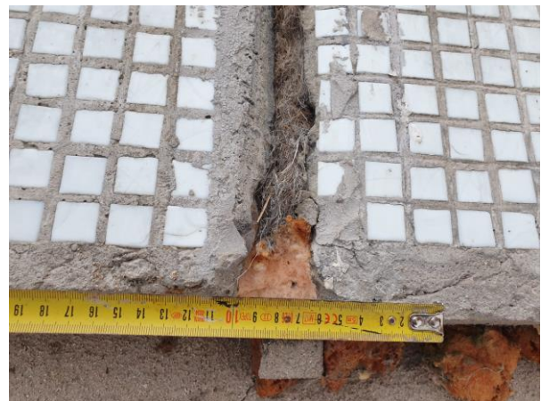
4.4.att. Starppaneļu vertikālā šuve ar pakulu un cementa javas blīvējumu. Zem pakulām uzstādīta neoprēna gumijas lenta. Cementa javas aizpildījums ekspluatācijas laikā zaudējis saķeri ar paneļu virsmu un daudzās vietās plaisā un izdrūp. Loka iela 13, Jelgava.
