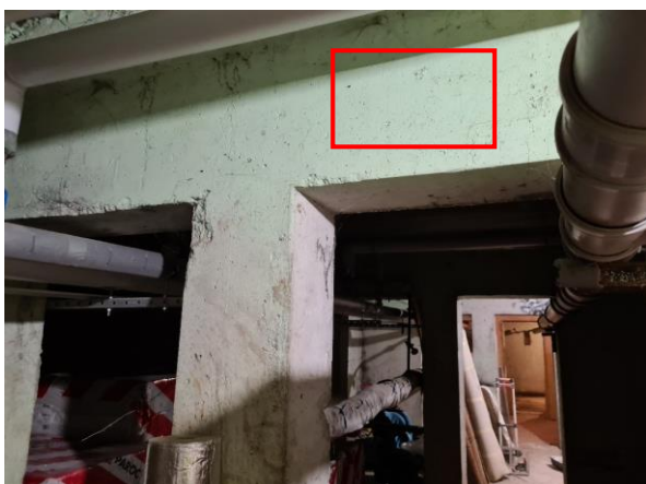
2.11.att. Pagraba nesošās sienas panelis ФП-2. Rudens iela 4, Rīga. Pēc Projekta betona marka M200 (C12/15).
