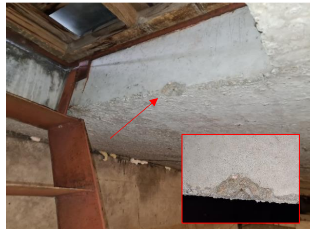
3.4.att. Ieejas mezgla jumtiņa dzelzsbetona plātne. Karbonizētais slānis vairāk par 10 mm. Rudens iela 4, Rīga.
