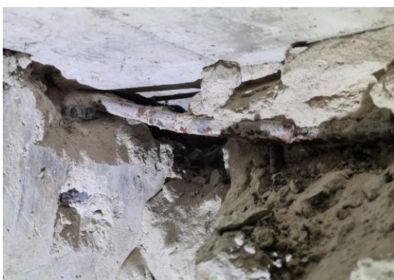
4.3.att. Paneļu ieliekamo detaļu savienojums ierīkots piemetinot gludu stiegru d12 mm (bez profilējuma) – vienā pusē pie ieliekamās detaļas plāksnes 80x80x8 mm, bet otrā pusē tieši pie d12 profilētās stiegras izlaiduma.
