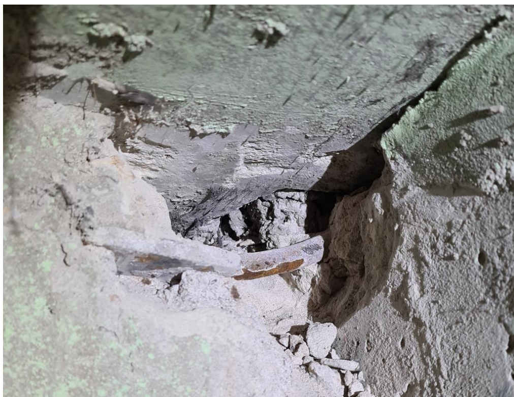
3.3.att. Atsegumā konstatēta ieliekamā detaļa 80x80x8 mm, kas piemetināta pie diviem stiegru d12 izlaidumiem. Paneļu ieliekamo detaļu savienojums ierīkots piemetinot vienu gludu stiegru d12 mm (bez profilējuma).
