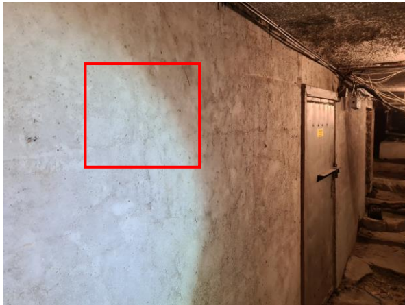
2.7.att. Kāpņu telpas sienas panelis ПК-25. Rudens iela 4, Rīga. Pēc Projekta betona marka M200 (C12/15).
