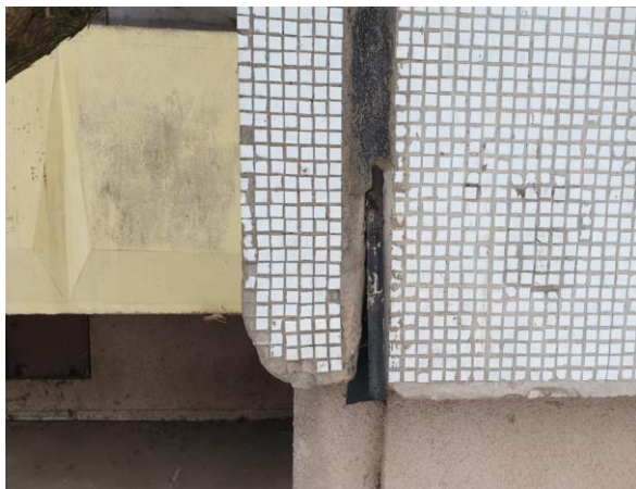
4.3.att. Starppaneļu vertikālā šuve ar poroizola un cementa javas blīvējumu. Zem poroizola uzstādīta neoprēna gumijas lenta. Cementa javas aizpildījums ekspluatācijas laikā zaudējis saķeri ar paneļu virsmu un daudzās vietās plaisā un izdrūp. Pērnavas iela 2, Jelgava.
