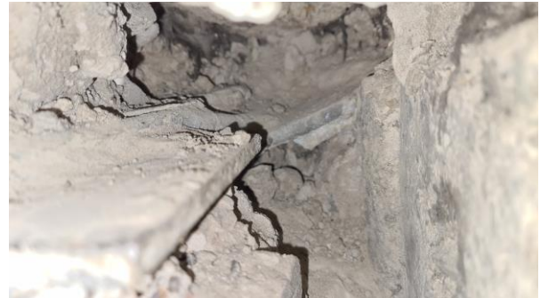
8.2.att. Atsegumā konstatēta ārsienas un šķērssienu paneļa ieliekamās detaļas 80x80x8 mm, pie kurām piemināta viena savienojošā gludā stiegra d12 (bez profilējuma). Konstatētas nebūtiskas korozijas pazīmes – aukstā cinka pretkorozijas aizsargslānis ir ierīkots.
