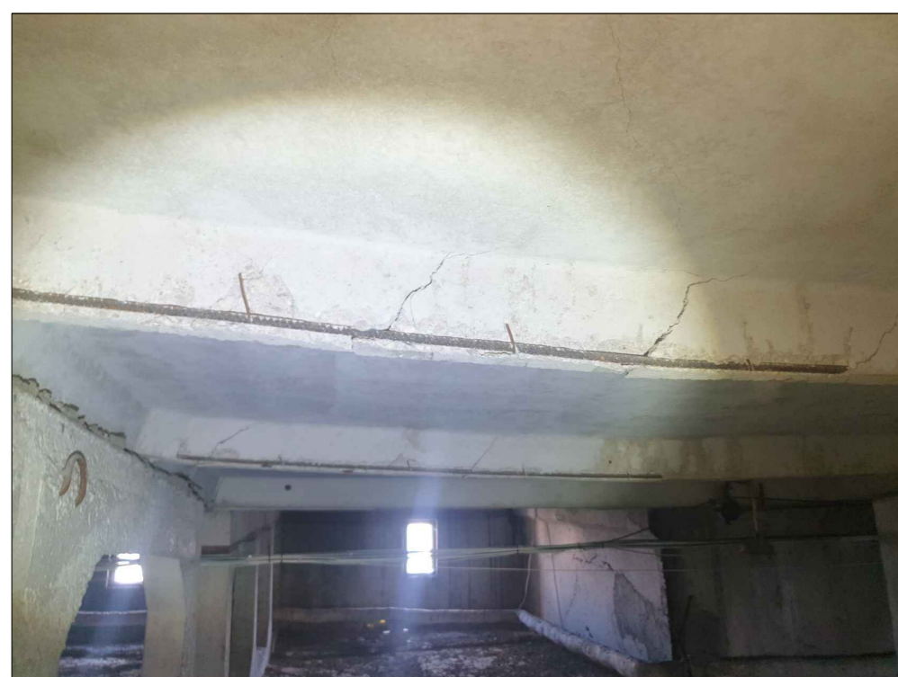
1.att. Bojātās jumta plātnes ribas attēls
