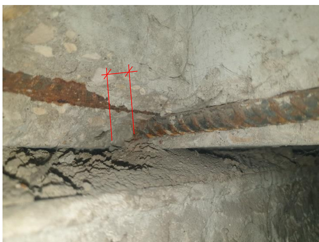
68.att. No plātnes balta enkurvietas izrāvusies garenstiegra
