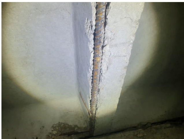
66.att. Skats uz ribas stiegru, kas ir zaudējusi saisti ar betonu
