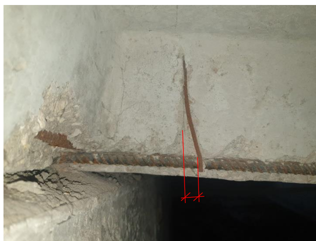
69.att. Garenstiegras izraušanas rezultātā deformēta šķērsstiegra, kas šobrīd notur garenstiegrojumu vietā
